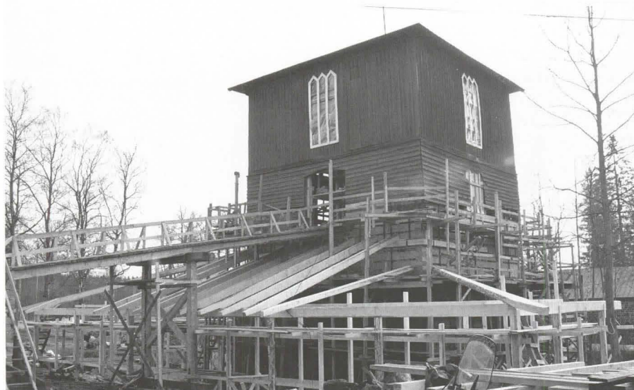
Uusi raastupa ja hiilisilta alkavat muotoutua. The new casting house and the coal bridge under construction.
