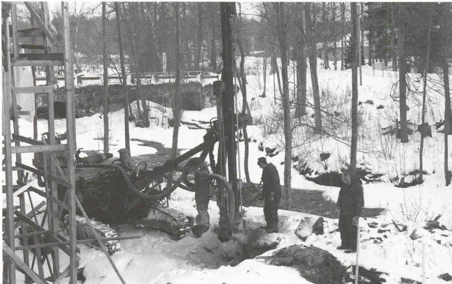
Masuunin uuden suojarakennuksen, raastuvan, perustuksia porataan. Drilling the foundation for the new casting house to protect the blast furnace.
