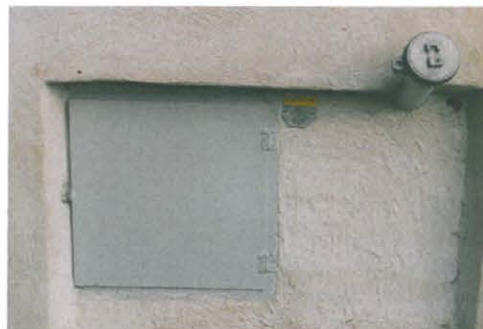
11) pannuhuoneen öljyputki luoteispäädystä
