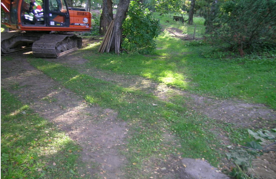
Kuva 1: Valvotun putkilinjan aluetta ennen kaivutyötä. Linja vedettiin alueelle, joka sijaitsee kuvassa kaivinkoneen kohdalta kuvan oikeaan alalaitaan. Taustalla lammashaka. Kuvattu itään. Kuvaaja: Sami Raninen. KYY 123: 2.
