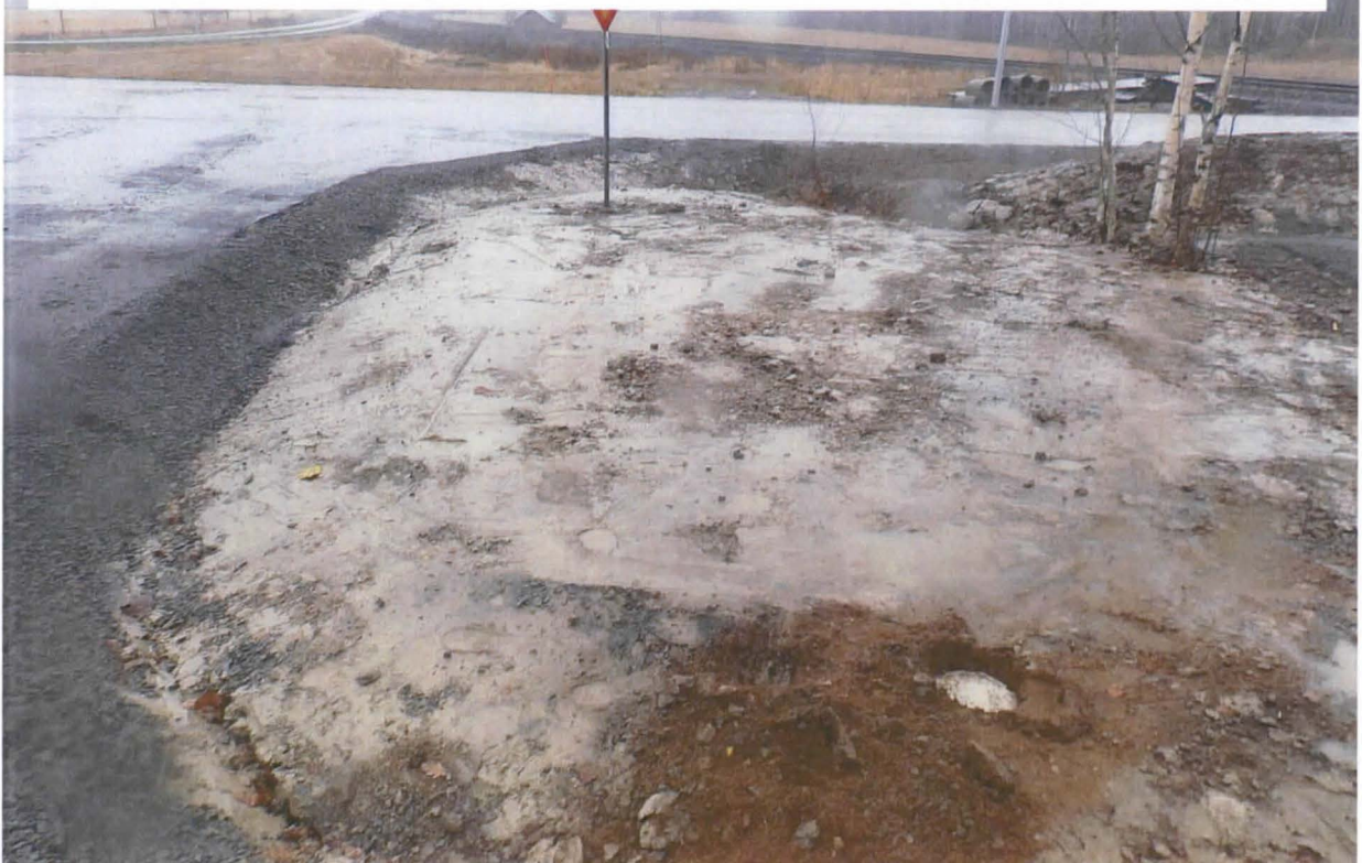
Kuva 6. Uuden tieliittymän alta kaivettua savea liittymän vierelle levitettyä ja tasoitettuna. Etualan punertava hiekkalaikku on peräisin paikalle tuodusta täyttöhiekasta. Kuvaussuunta länteen. Kuva: Ulla Moilanen/Pirkanmaan maakuntamuseo
