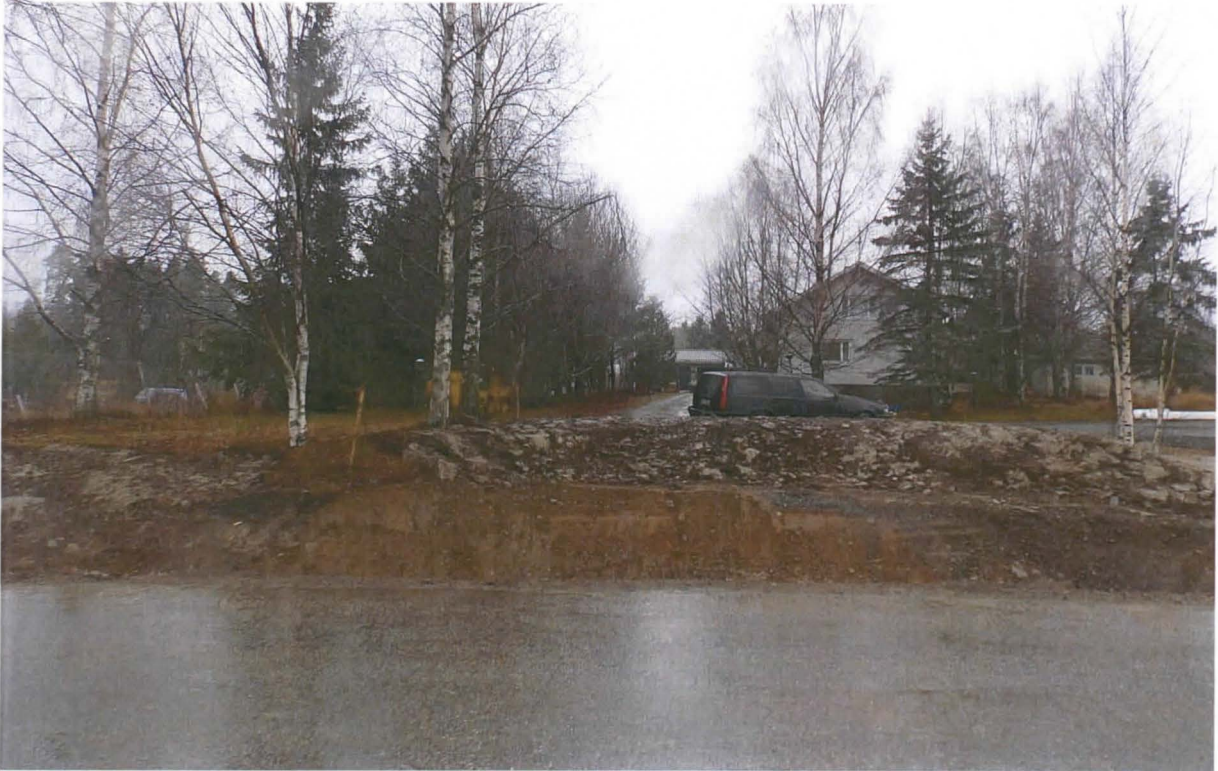
Kuva 9. Yleiskuva Kaukolantieltä vanhan tieliittymän suuntaan. Liittymän päälle on kasattu paikalta kaivettua vanhaa, savista peltokerrosta. Kuvaussuunta länteen. Kuva: Ulla Moilanen/Pirkanmaan maakuntamuseo.
