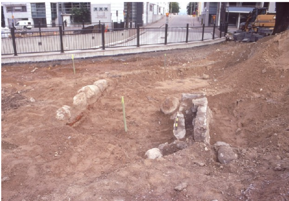
Kuva 15: perustukset 1 ja 2 esiin kaivettuina. Vasemmalla perustus 2 ja oikealla perustus 1. SE. KyM/M. Kykyri.
