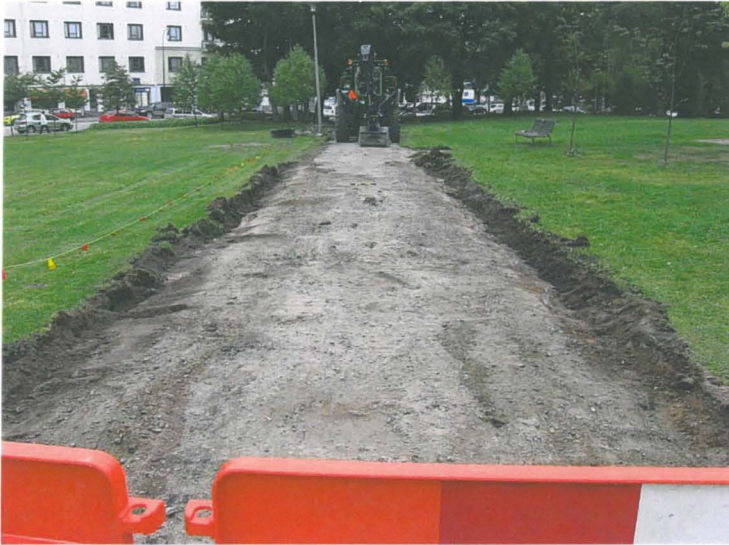
Kuva 22: Käytävää 2 kaivetaan lopulliseen syvyyteensä. Samoin kuin käytävä 3:n aluetta, ei myöskään käytävää 2 syvennetty kuin sen reunoilta, jotka varustettiin myöhemmin nupukivisin vesiurin. Vanha asvaltin hiesupohjustus jätettiin uuden betonikivikatteen alle. W. KyM/M. Kykyri.
