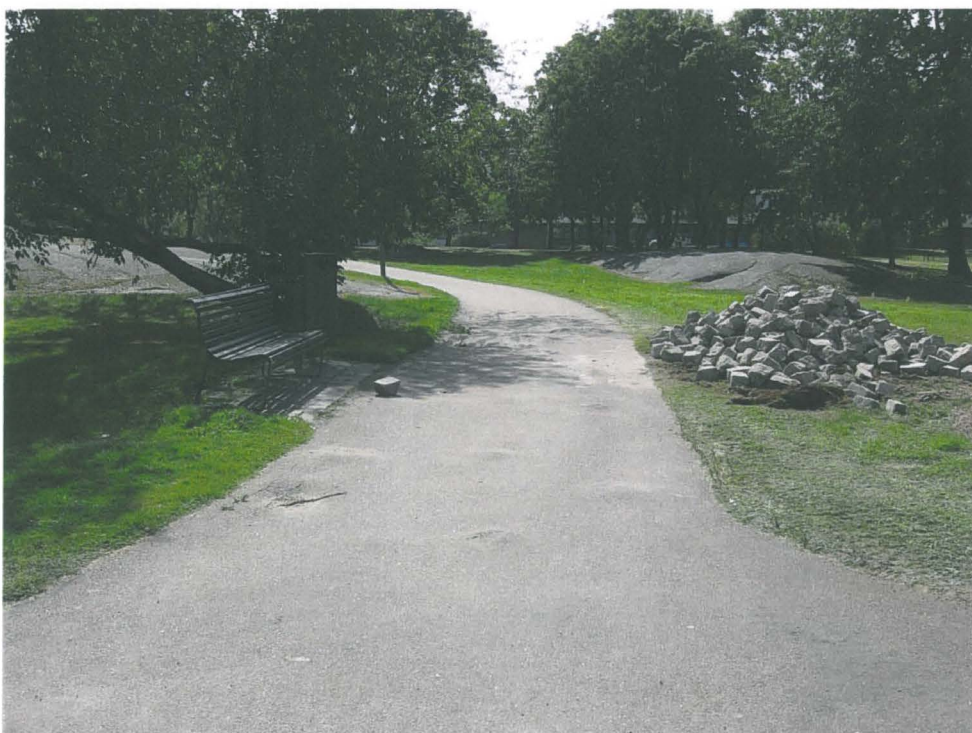
Kuva 12: Käytävä 3:n N-pää ennen saneeraustöiden aloittamista. Kuvan keskiosassa näkyy roudan asfalttipinnalla aiheuttamia vaurioita. N. KyM/M. Kykyri.
