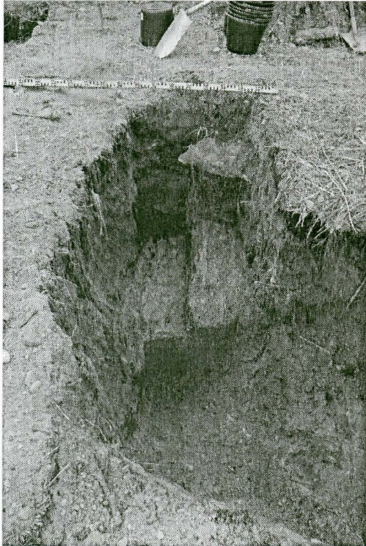
Kuva 11. Lappeenranta, 6-tien varsi, sähkötolppa 27. Koekuoppa 15 pohjalta esiin tullutta betonia. Kohti S. Kuva: K. Nordqvist.
