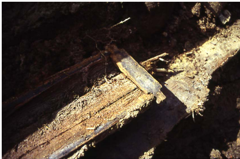
Kuva 17. Viemäriin rakenteen liitospuu.
