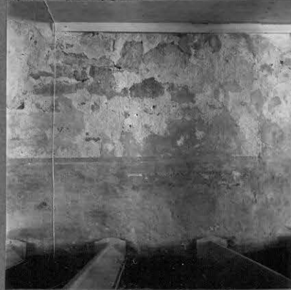
ETELÄSEINÄN KOSTEUDEN RADAUTTAMA LAASTIA LEHTERIN ALAPUOLELLA
