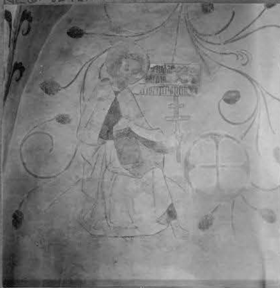
KUORIN POHJOISSEINÄN MAA- LAUS ENNEN PUHDISTUSTA.
