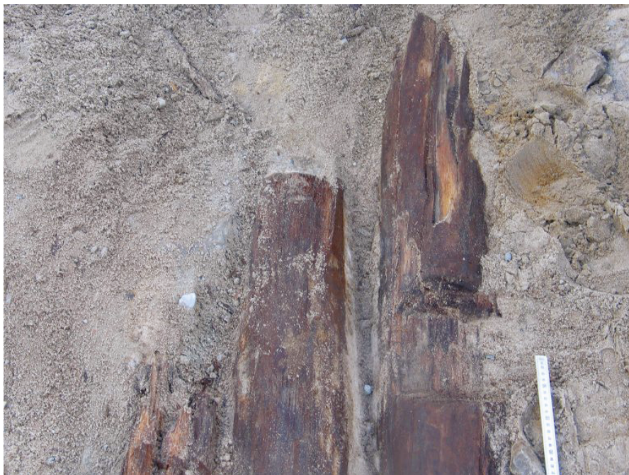
Kuva 16. Salvoksia katusillan hirsissä (R35F) (digitaalikuva 108, TKPK-06).
