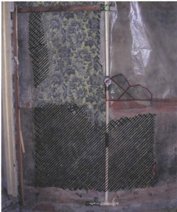
KUVA 6 POHJOISSEINÄN ALAOSAN TAPETTIFRAGMENTIN VAURIOIDEN KARTOITUS.
