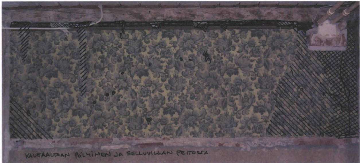
KUVA 1 ETELÄSEINÄN TAPETIN VAURIOKARTOITUS. MERKKIEN SELITYKSET EDELLISELLÄ SIVULLA.
