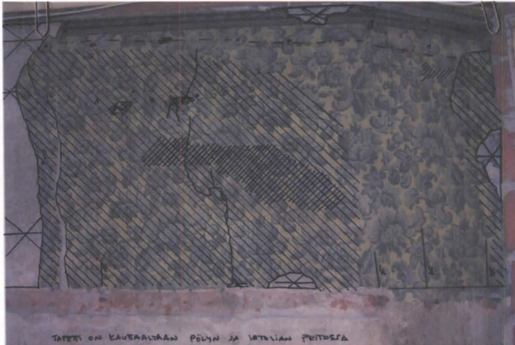
KUVA 3 VAURIOKARTOITUS LÄNSISEINÄN POHJOISESTA TAPETTI -FRAGMENTISTA SEINÄN YLÄOSASSA.
