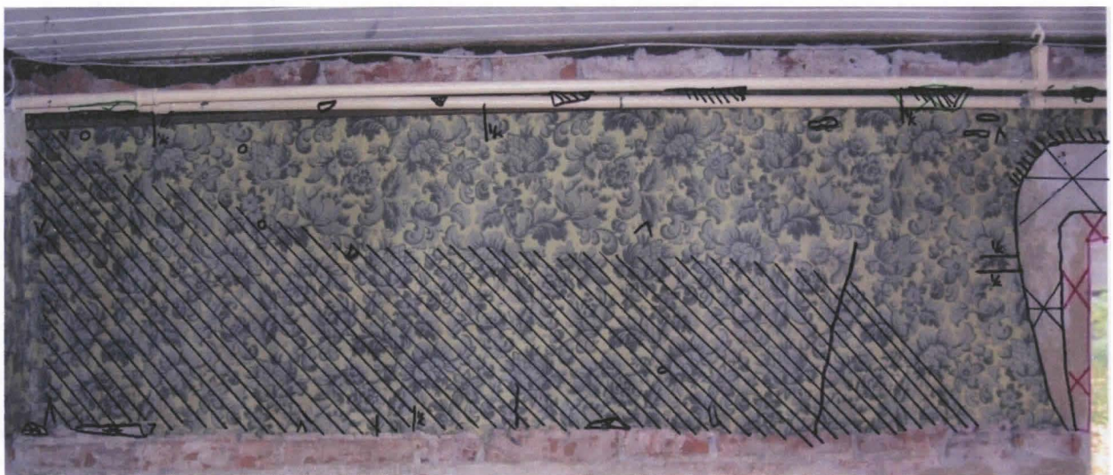
KUVA 2 LÄNSISEINÄN ETELÄINEN OSA. SUURI PUUTTAVA ALUE JATKUU KUVASTA OIKEALLE.
