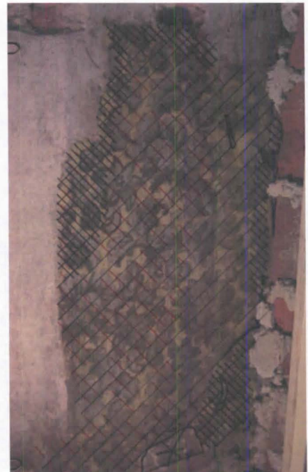
KUVA 4 LÄNSISEINÄN POHJOINEN TAPETTI SEINÄN ALAOSASSA.
