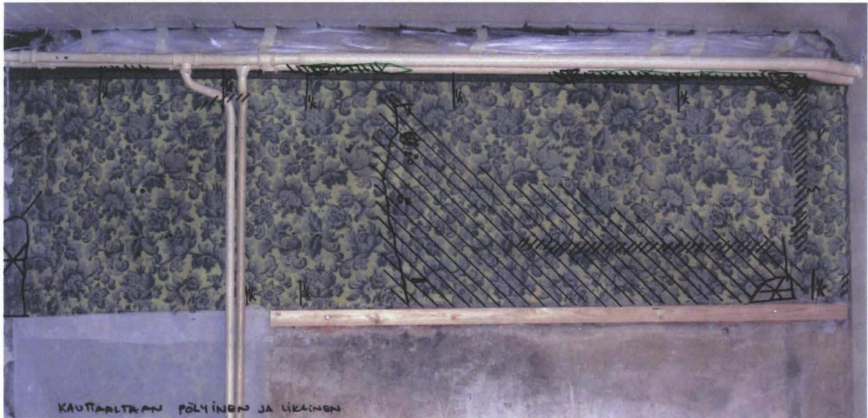
KUVA 5 POHJOISSEINÄN YLÄOSAN TAPETIN VAURIOIDEN KARTOITUS.
