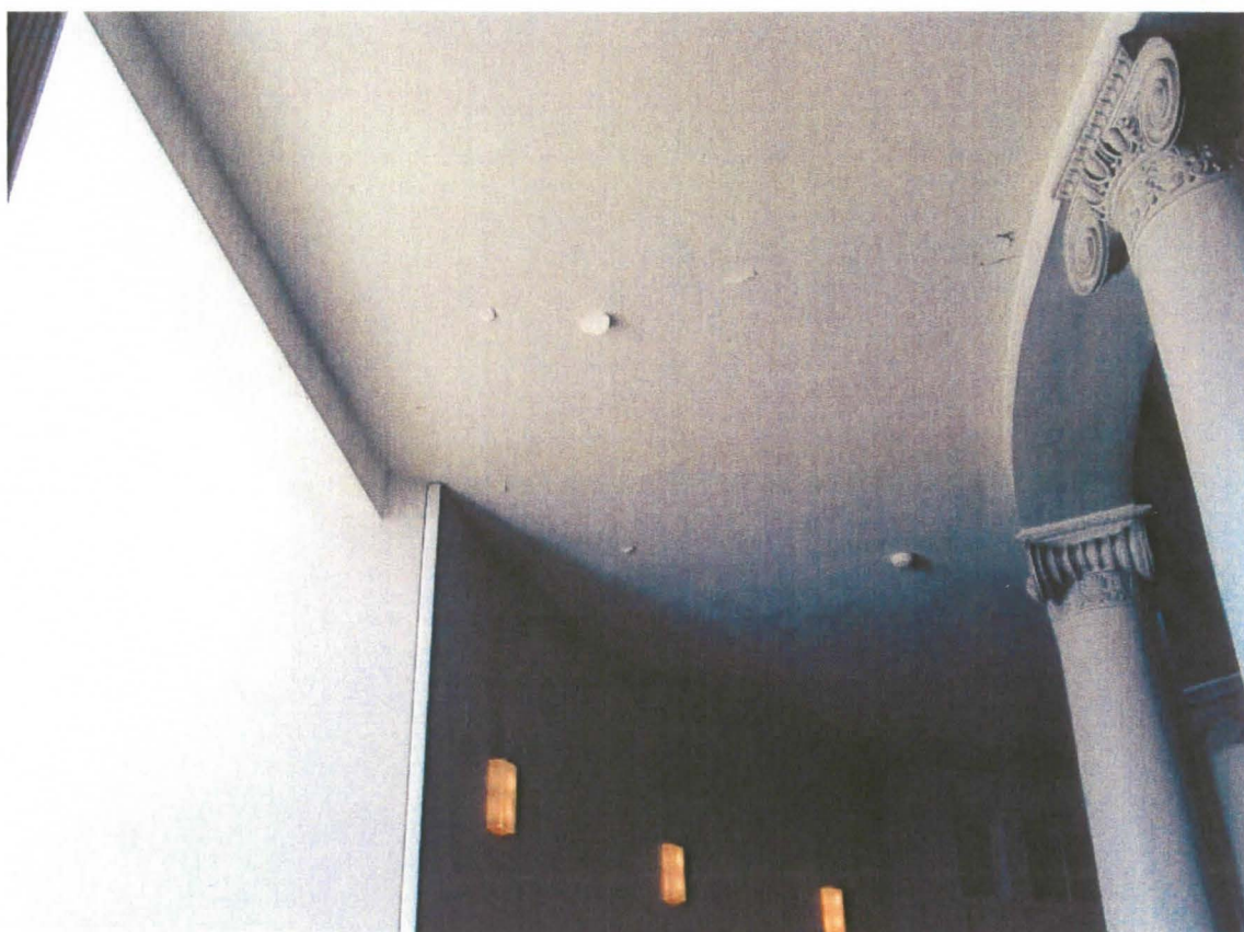
Kuva 5.2 Maali- ja tasoitepinnan lohkeamia lehterin alapinnassa.
