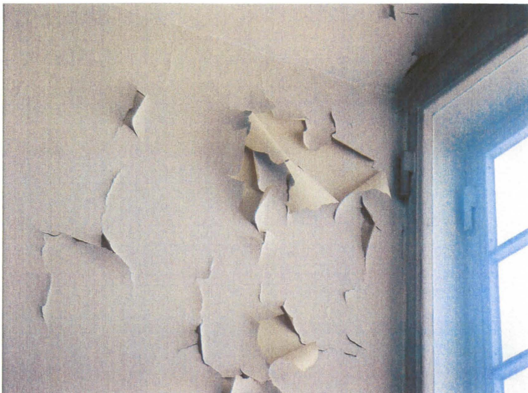
Kuva 5.5 Etelälehterin lännenpuoleisen ikkunan maali- ja tasoitepinnan lohkeilua.
