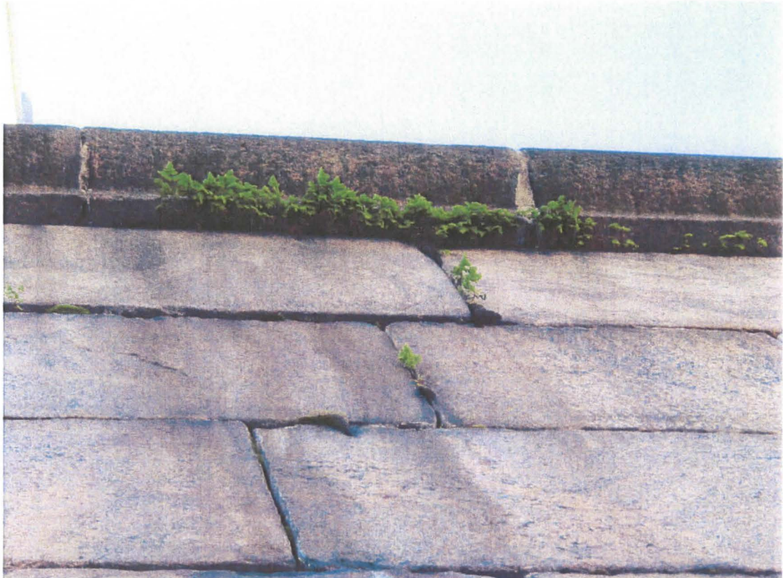
Kuva 2.5 Kirkkokadun muurin korjaamattomalla osalla saumalaasti on pitkälle rapautunut, saumoissa kasvaa sammalta ja muita pieniä kasveja. Joitakin kiviä on pullistunut muutamia millimetrejä ulospäin muuten suorasta muurista.
