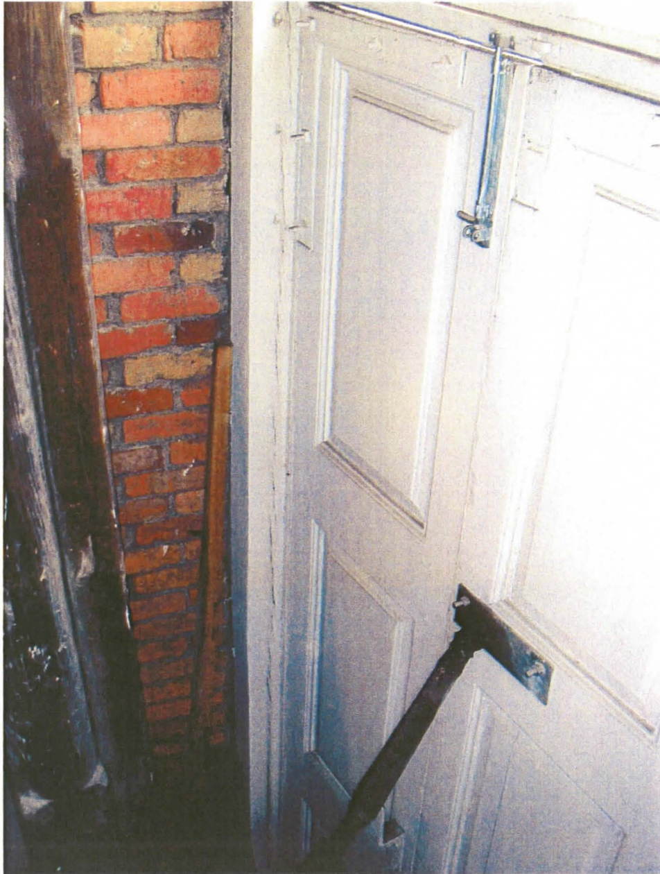
Kuva 6.7 Kellotapulin oviluukkujen karmirakenteissa oli havaittavissa halkeilua.
