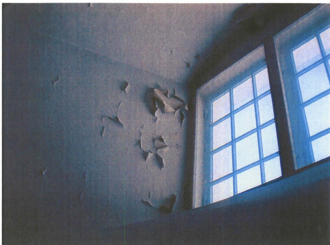
Kuva 5.6 Etelälehterin lännenpuoleisen ikkuna-aukon maali- ja tasoitepinnan lohkeilua.
