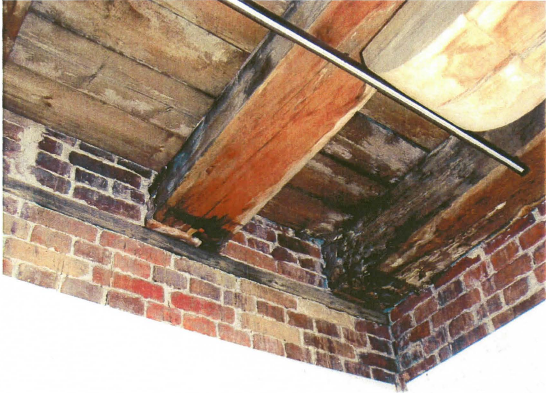
Kuva 6.10 Kahvilan yläpuolinen välipohja on kannatettu järeillä puupalkeilla. Palkkien pää on upotettu tiiliulkoseinään. Palkeissa oli paikoitellen jälkiä vesivuodoista sekä mahdollisista lahovaurioista.
