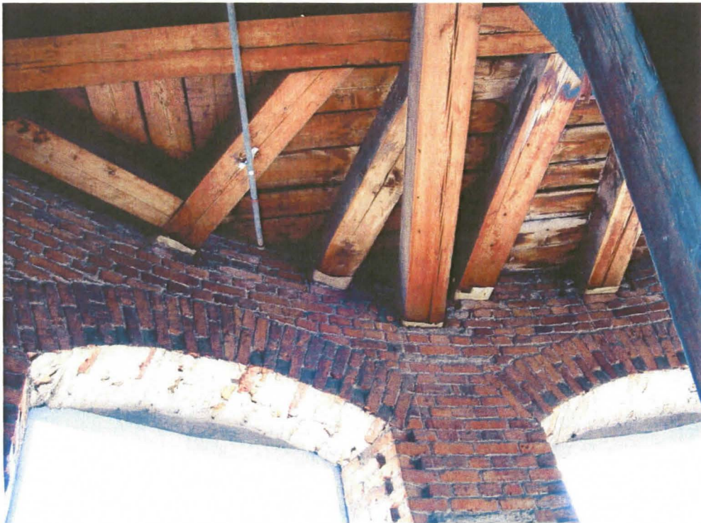
Kuva 6.1 Tiiliseinäen upotettujen puukannattimien päät oli suojattu tuohella ja tervauksella
