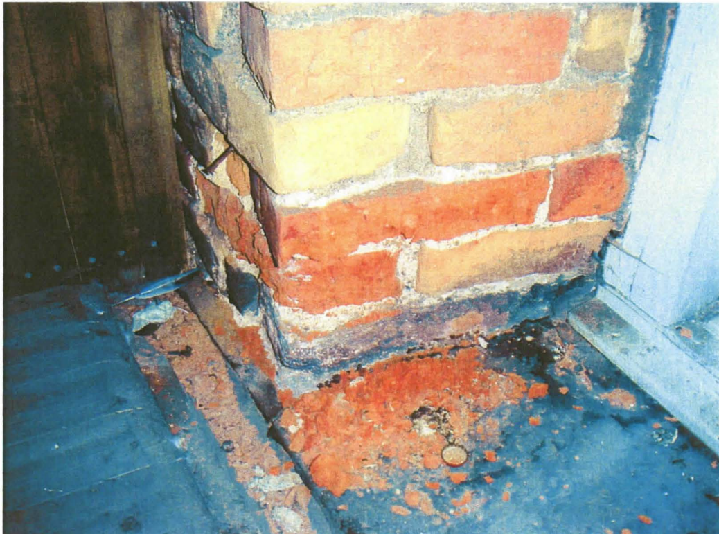
Kuva 6.8 Oviluukkujen vieressä olevat tiiliseinät olivat märkiä. Seinien alaosissa oli rapautuneita tiiliä.
