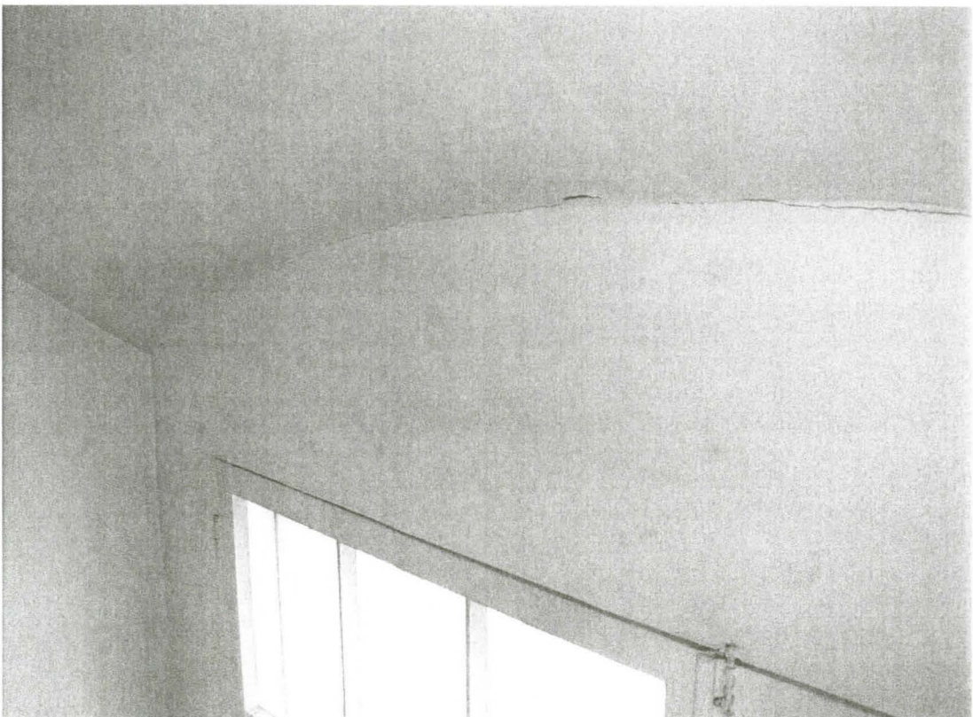
Kuva 5.4 Etelälehterin keskimäisen ikkunan halkeilu ei mene tasoitetta syvemmälle.
