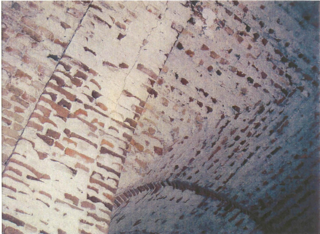
Kuva 4.5 Kryptan kattoholveissa havaittiin halkeilua.
