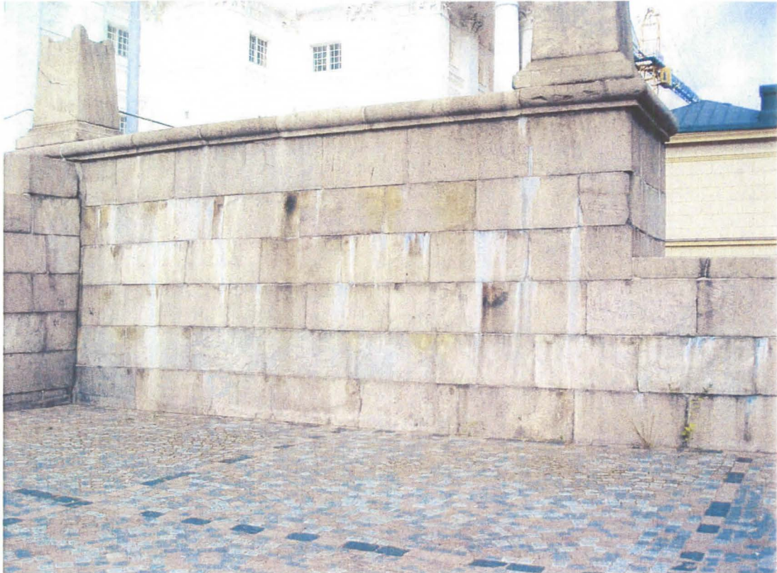
Kuva 2.1 Luonnonkivimuurin laastisaumoissa esiintyy runsaasti kalkkivalumaa. Ruskeat jäljet kivien pinnoissa ovat seurausta kivien kiinnitykseen käytettyjen metallihakojen ruostumisesta.
