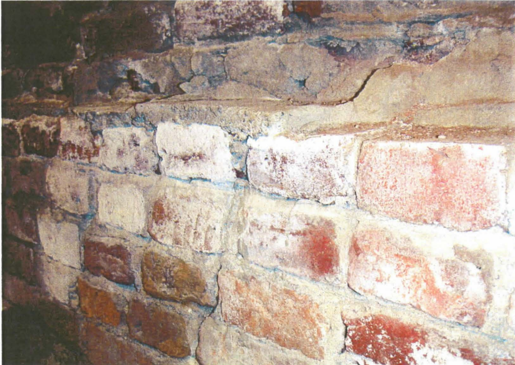
Kuva 6.5 Joissakin seinänosissa todettiin merkkiä tiiliä sekä runsaasti kalkkihärmettä tiiliseinän sisäpinnassa. Tässä kohdin märkyys johtuu todennäköisesti katon kautta kulkeutuvasta vedestä (kohdan yläpuolella tai lähellä apostolipatsas).
