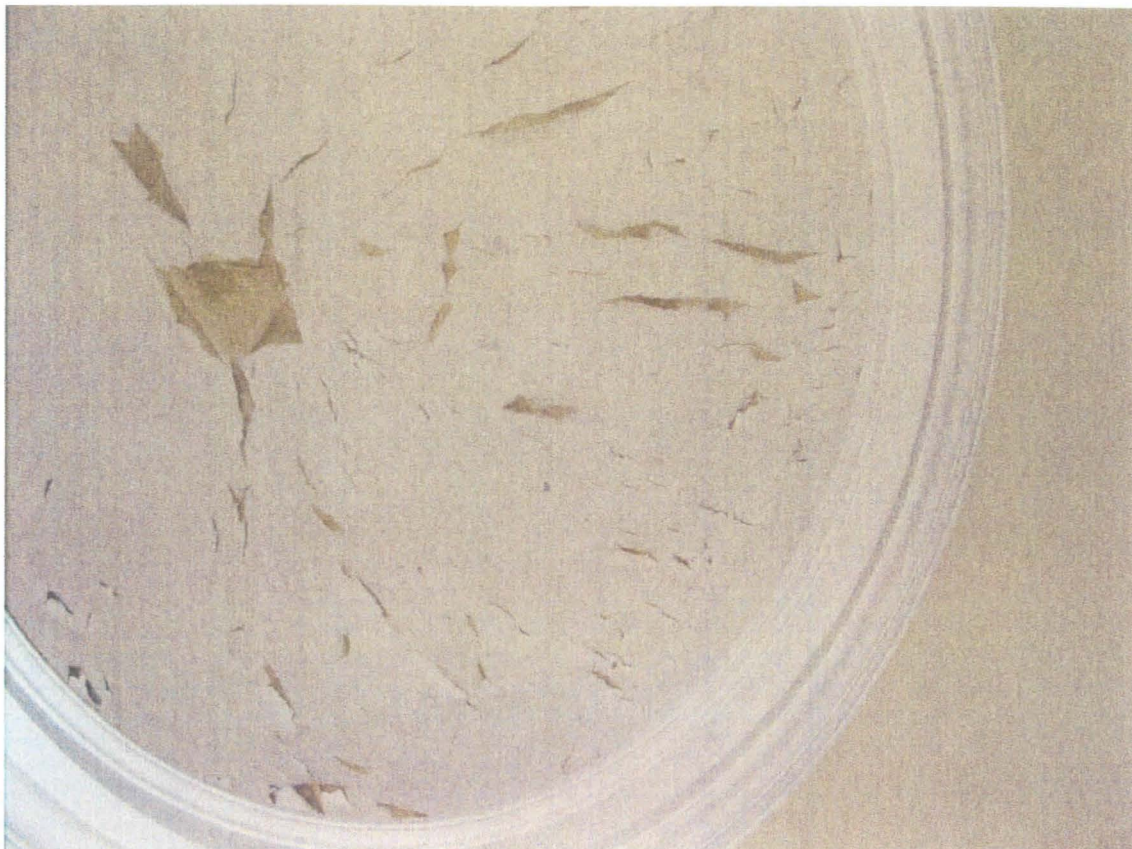
Kuva 5.8 Alttarilehterille johtavissa eteläpuolen kierreportaikossa katon maali- ja tasoitepinta lohkeilee pahasti.
