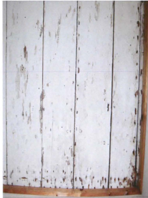
Valokuvassa esimerkki katon maalivauriosta. Kuvassa myös naulauksen jättämiä reikiä.
