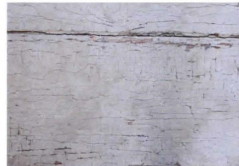
Lattian krakeloitunutta maalipintaa
