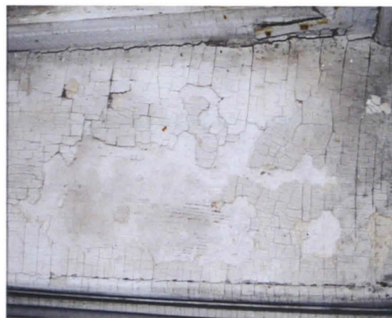
Smyygin maalinirtoilua ja likavaurioita (1)
