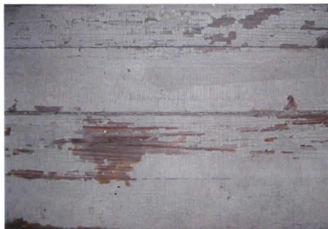
Maalipinta on tasaisen krakeloitunut ja irtoilee paikoitellen puulle asti (1)
