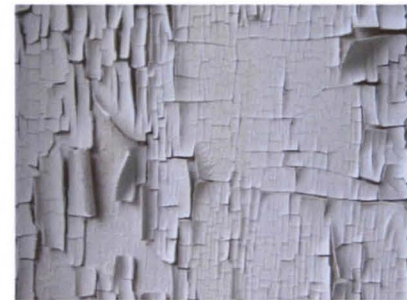
Eteläpuoleisen ikkunan smyygistä maali kuorittuu irti (2)
