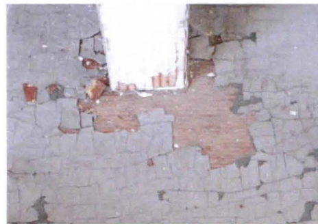
Maalikerrokset ovat paikoitellen irti puuhun asti (2)
