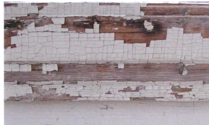
Ikkunan alakarmin maalipinta irtoilee (2)
