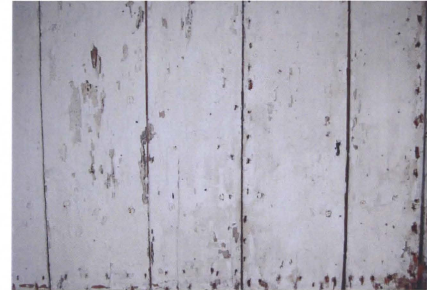
Katossa on runsaasti naulanreikiä
