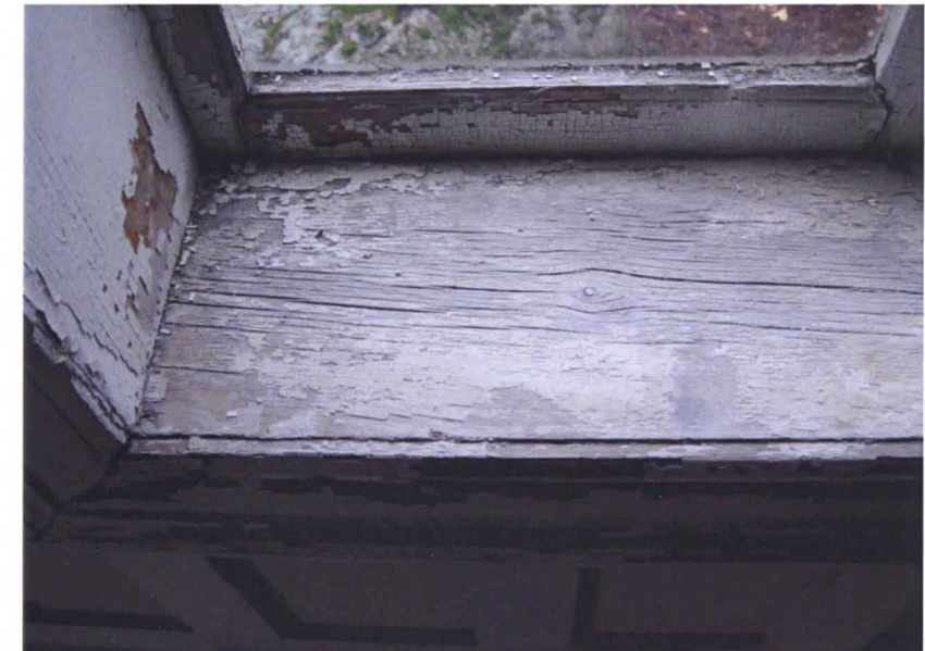
Eteläikkunalaudan maaleista on irronnut suurin osa
