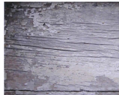
Ikkunalaudan maalipinta on irronnut paikoitellen puulle asti (3)
