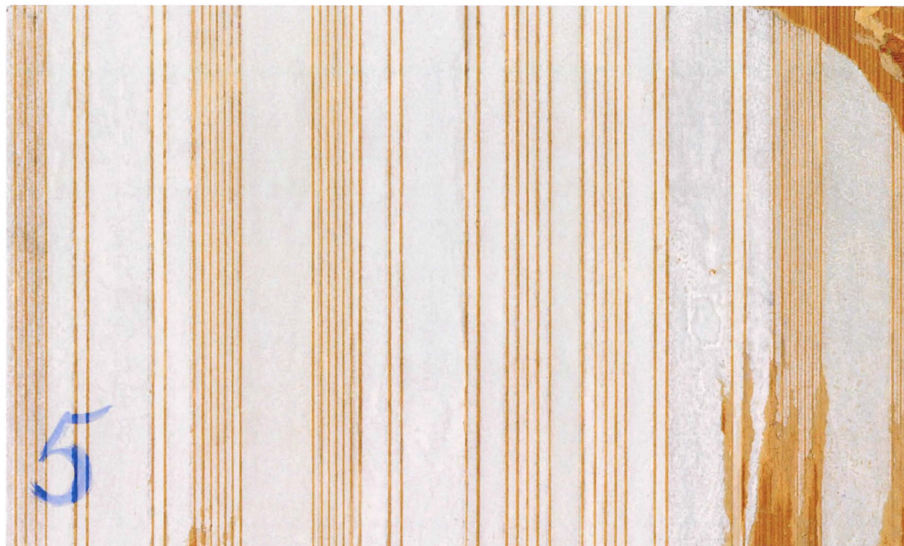
Kuvat vasemmalla: Raidallista tapettia on pieninä fragmentteina seinän yläosassa ja kosteusvaurioita kärsineenä penkin alla
