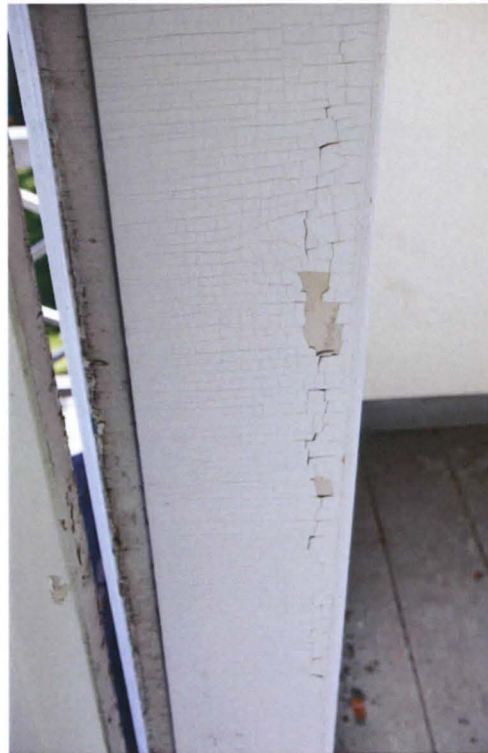
Oven smyygit ovat kauttaaltaan krakeloituneet. Kuvassa myös maalin irtoilua (1)
