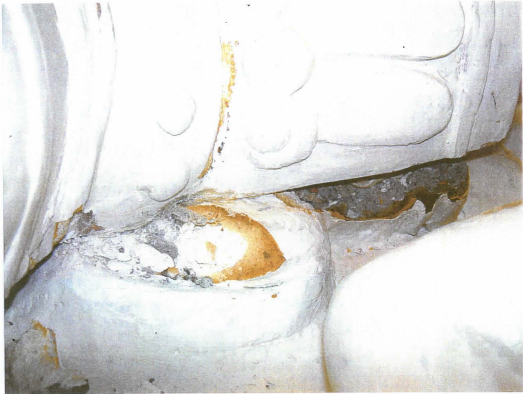
Kuva 34. Kipsireliefin maalipinnan alla esiintyvää rakennevaihtelua
