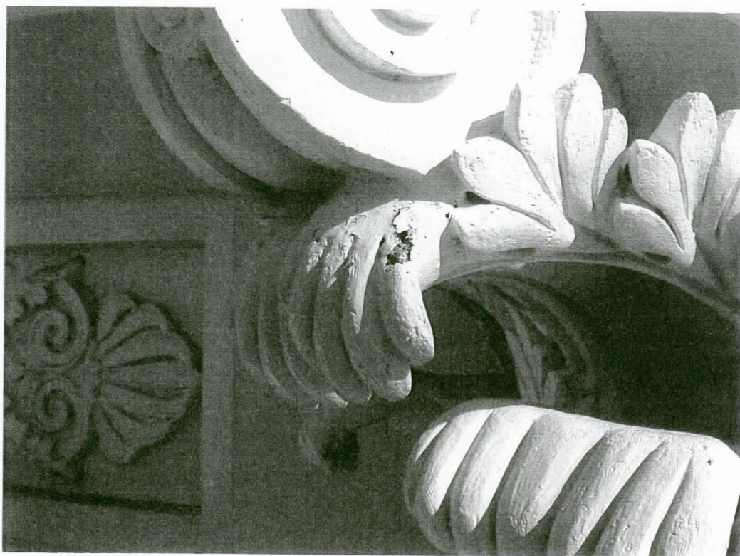
Kuva 27. Vaurioitunut kapiteelin osa, joka voidaan vaihtaa tai korjata
