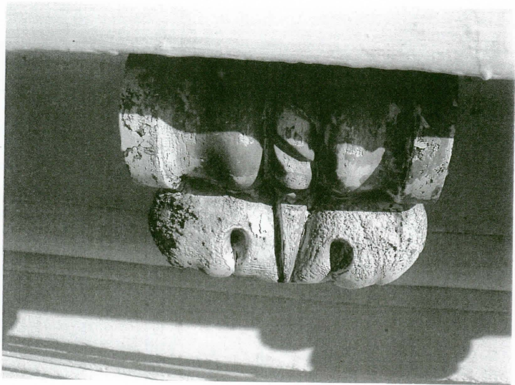
Kuva 31. Eriasteisia vaurioita konsolin kärkiosassa
