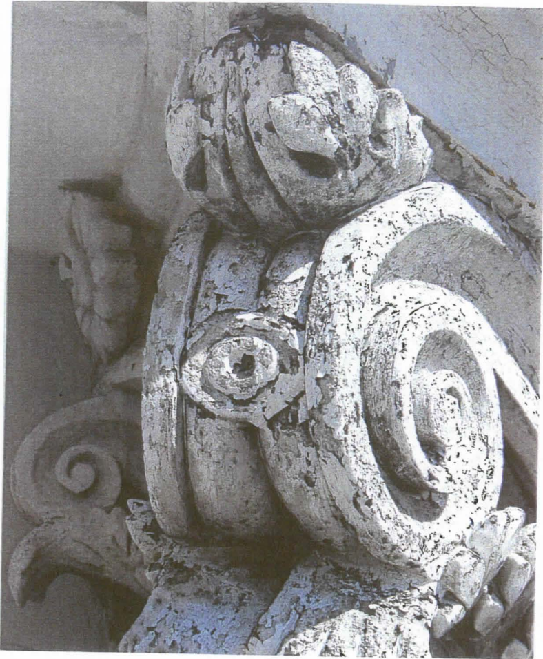
Kuva 7. Kellotornin vaurioituneen kipsikapiteelin kärkiosa
