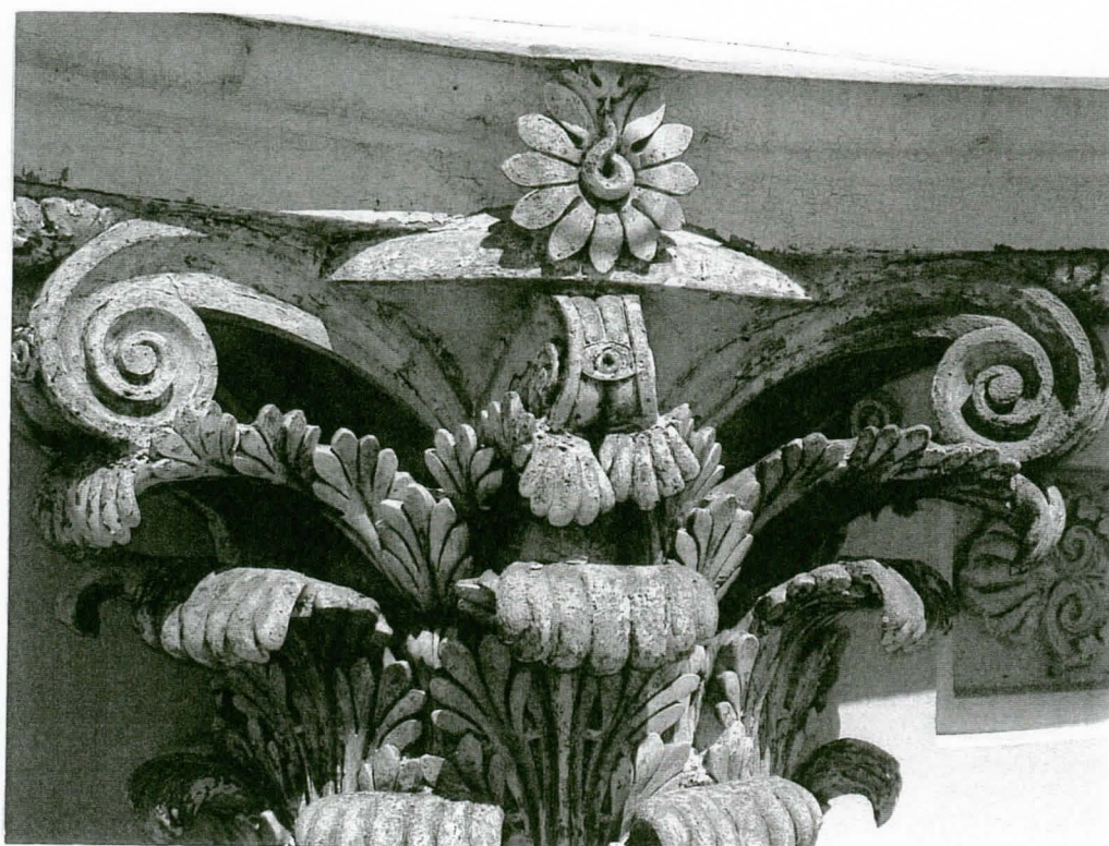
Kuva 28. Vaurioitunut kapiteeli, joka tulisi vaihtaa
