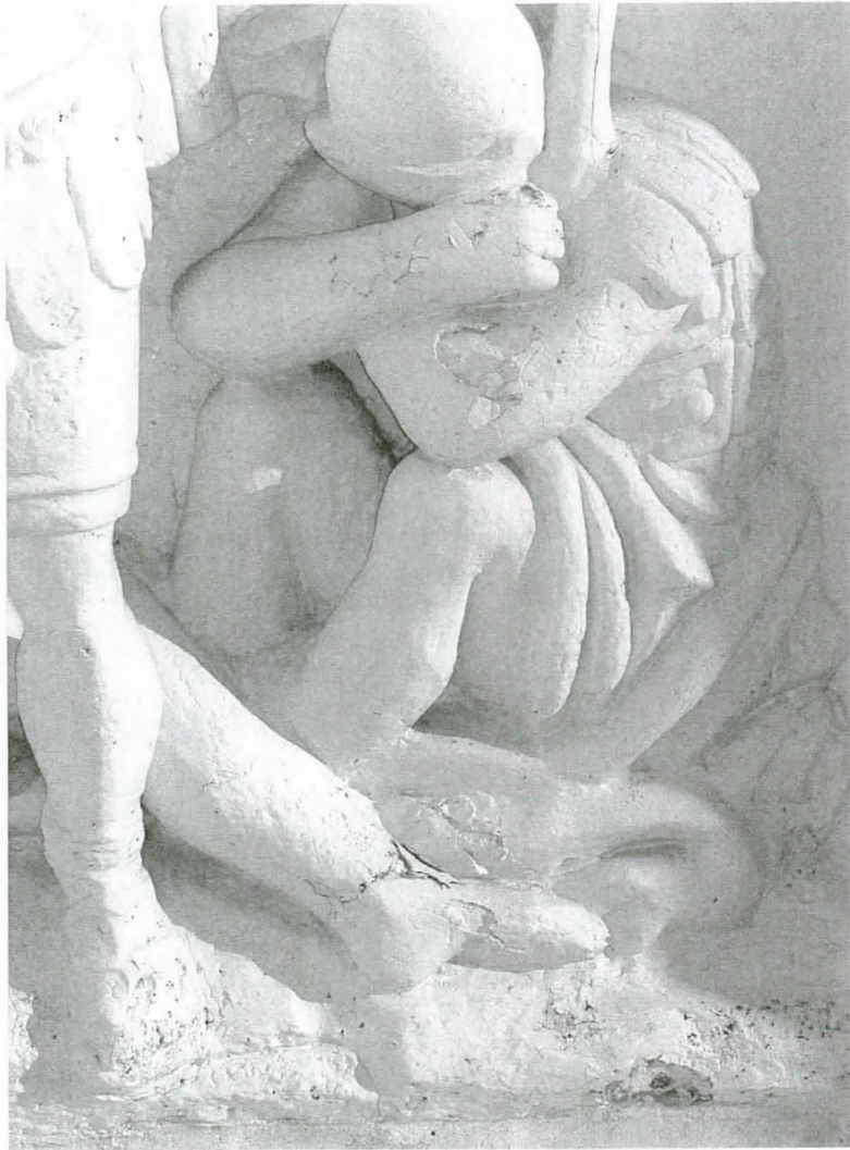
Kuva 33. Yksityiskohtia eteläseinän kipsireliefin vaurioista
