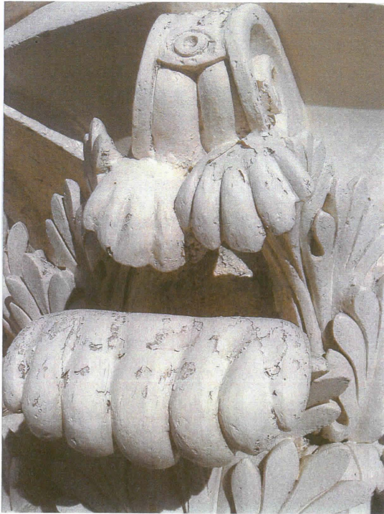
Kuva 25. Välittömästi korjattavissa oleva maalivaurio
