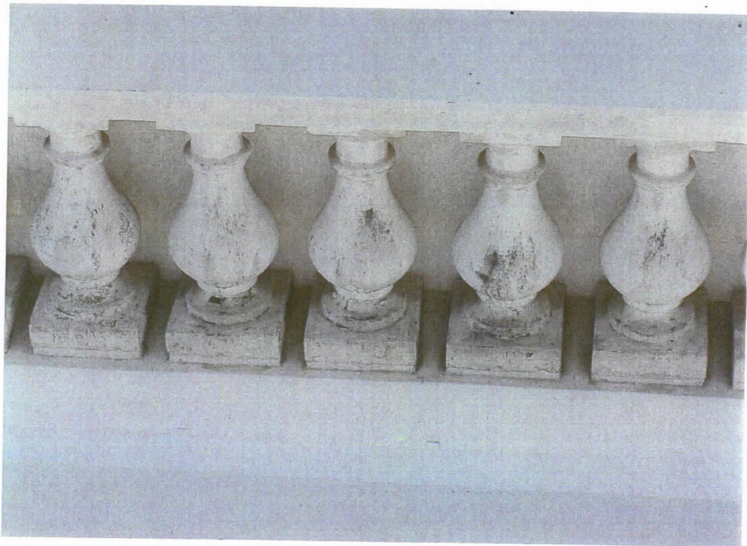
Kuva 26. Välittömästi korjattavissa oleva maalivaurio
