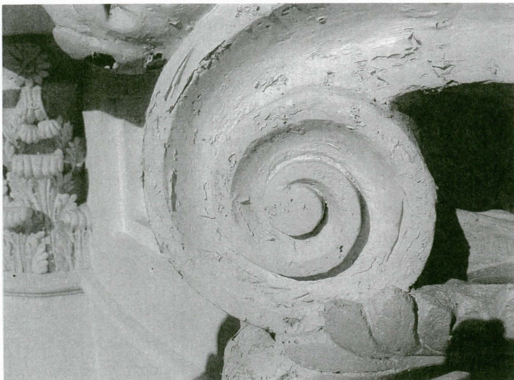
Kuva 24. Välittömästi korjattavissa oleva maalivaurio
