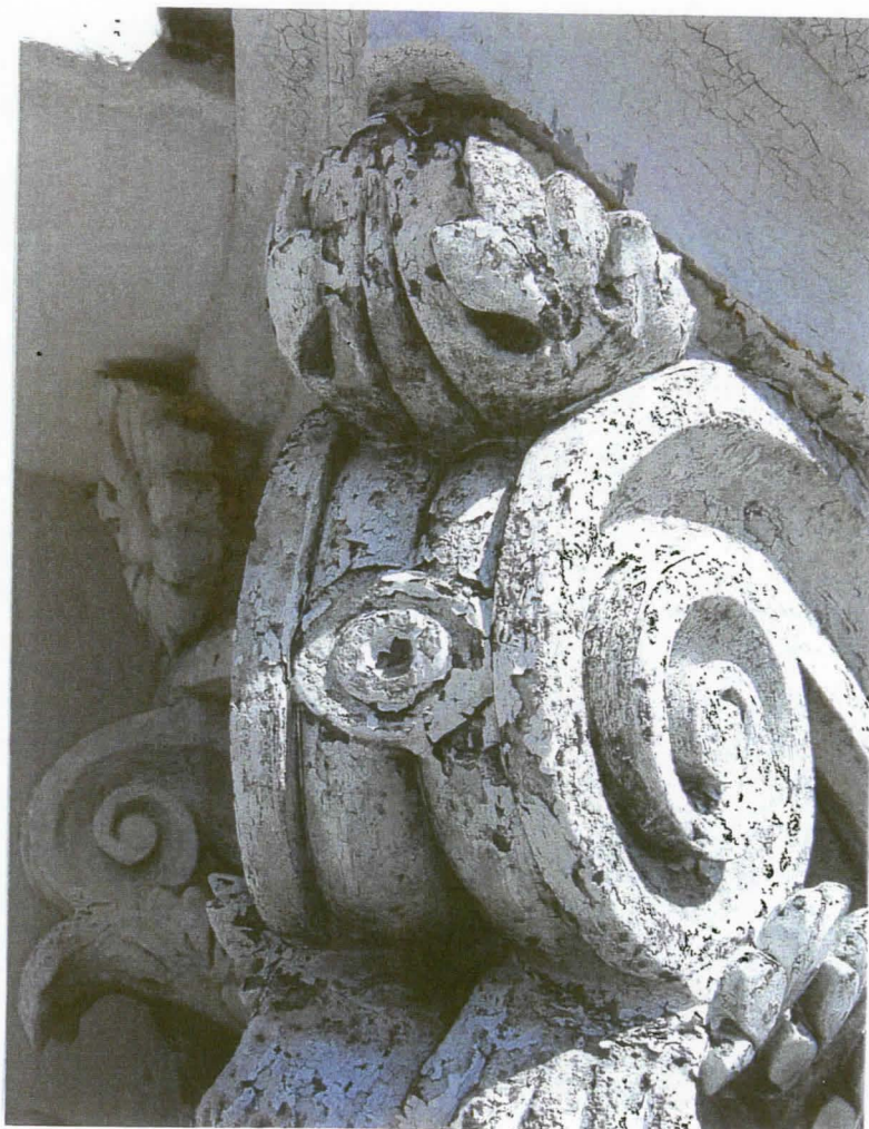
Kuva 30. Pahasti vaurioitunut kapiteelin osa, jossa esiintyy eriaasteisia syöpymiä
