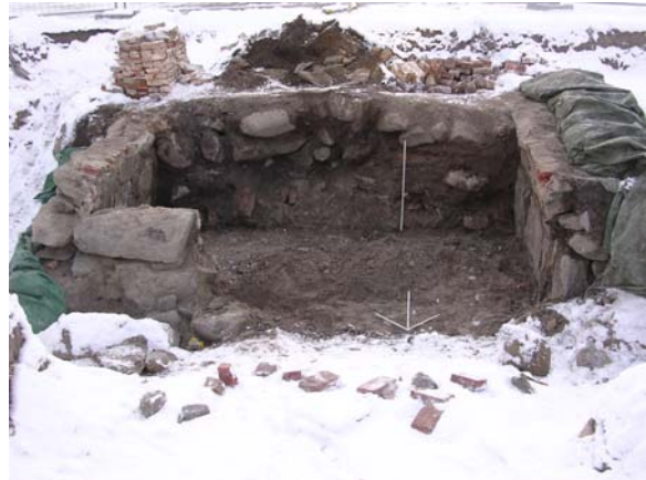
A2: pohjoisseinästä purettu tarvittava osa, kellari jatkuu etelään. 19.12.2006, suunta: etelä, kuvaaja: Janne Haarala
