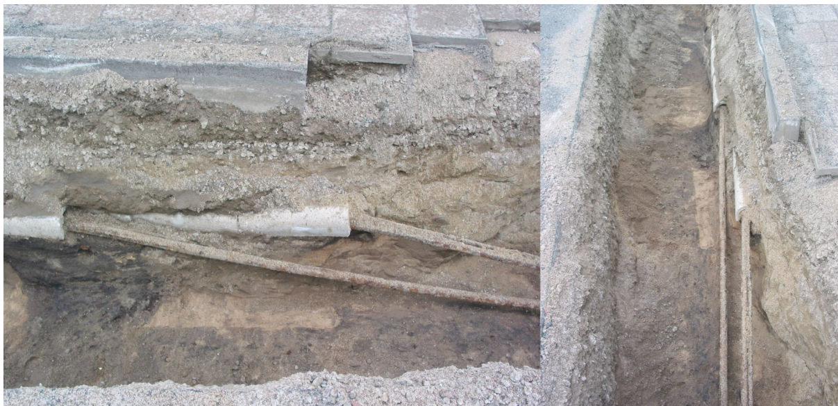
Kuva 6, Kuninkaankadun kaivannon eli alue 7:n länsipää. Eteläprofiilissa näkyy yksi monista jätekuopista (?) kadun profiilissa. Oikeanpuoleisessa kuvassa alue 7:n taso, jossa näkyy nokisen hiekan täyttämä ura, peltohiekkaa ja hienoa vaaleaa pohjahiekkaa. Nokiojasta löytyi mm. hiokin kiven katkelma. Kuva: Markus Kivistö
