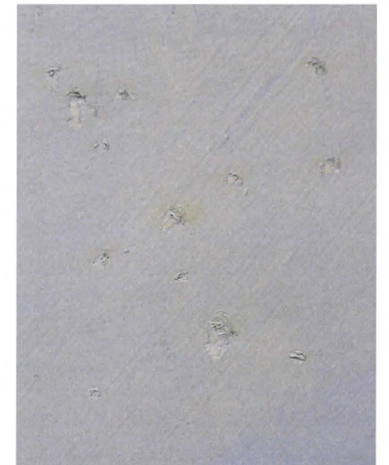
5. Ilmeisesti jo maalausvaiheessa syntyneitä vaurioita, joissa tuore maali on rullaantunut jonkun tylpän esineen painalluksesta. Esimerkki kuvakentästä 12.
