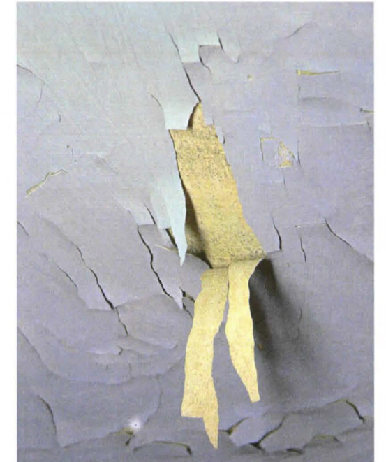
3. Kuvakentässä 8 hilseily on niin voimakasta, että siitä roikkuu maalikielekkeitä.
