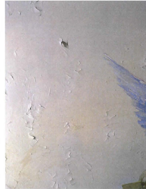
2. Maalikerrokset ovat halkeilleet ja irronneet pohjastaan. Esimerkki kuvakentästä 2.
