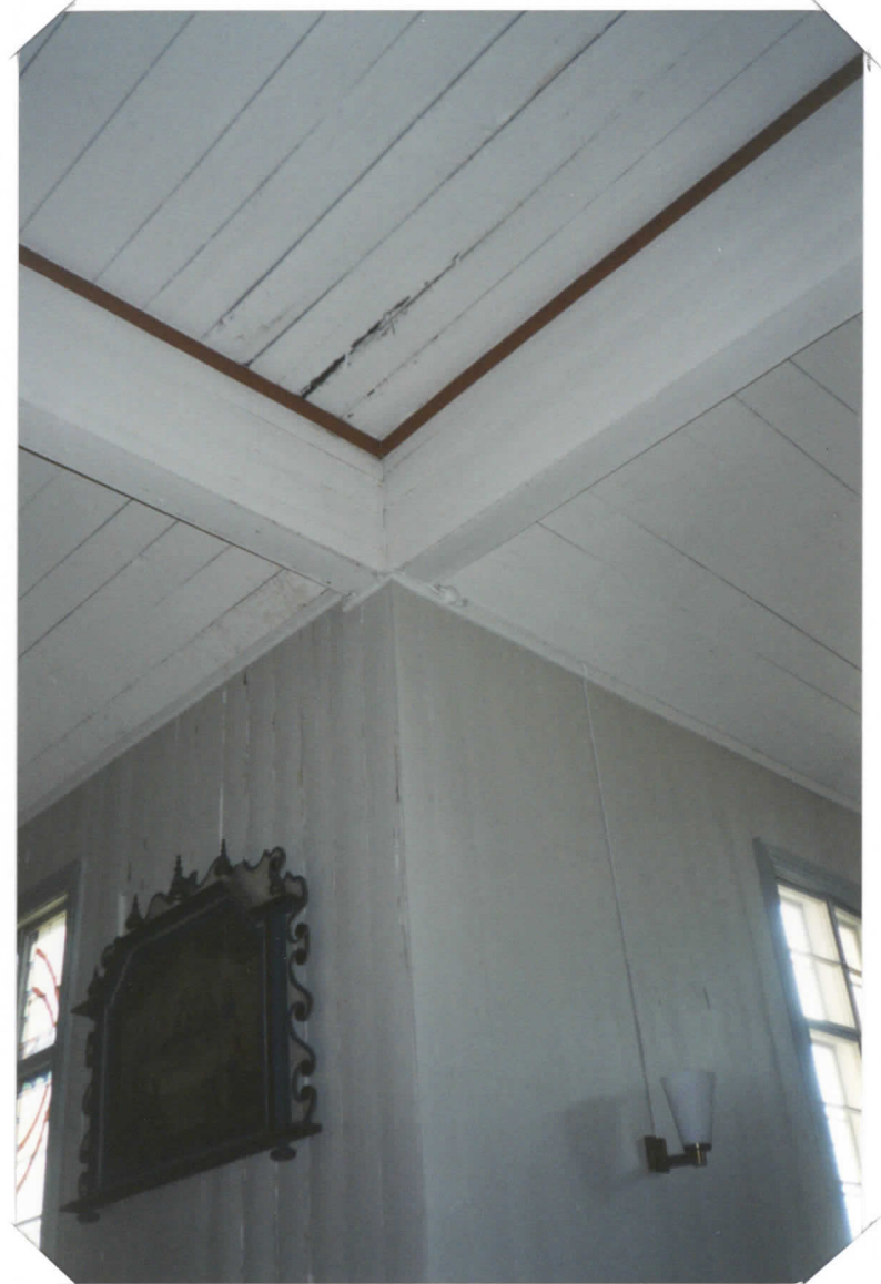
KOSTEUSVAURIO / KESKIKATON ES-KULMAUS
