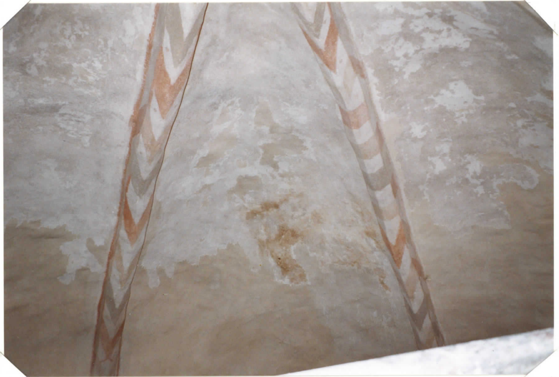
ASEHUONEEN PÖHJOISYMPÄRÄN VANHAA KOSTEUSJÄLKEÄ
