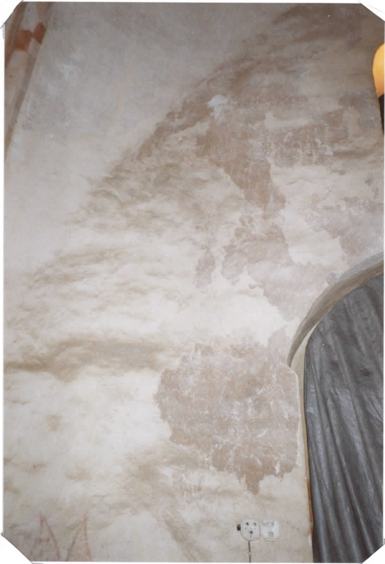
ASEHUONEEN KÄELÄSEINÄN ESILLE TUULTA LIKAANTUNUTTA PINTAA
