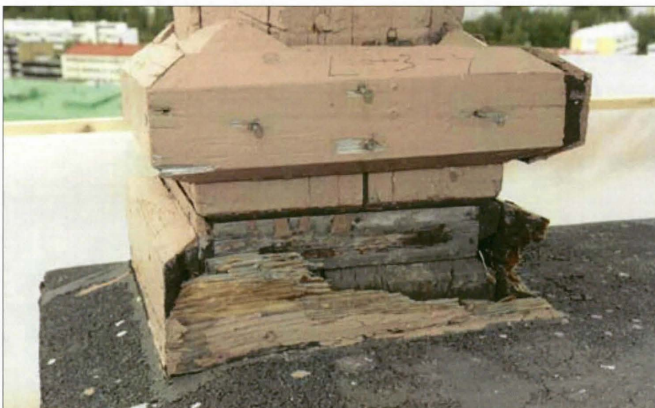
Länsinurkan pilarin verhousten alta paljastui vaurioitumaton alkuperäinen pilari.
