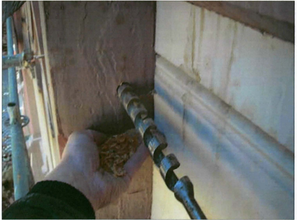
Vesikatonlta pilasterin päähän vuotanut vesi oli aiheuttanut pientä lahoamista. Korjaukseen riitti pienehkö puupaikkaus.
