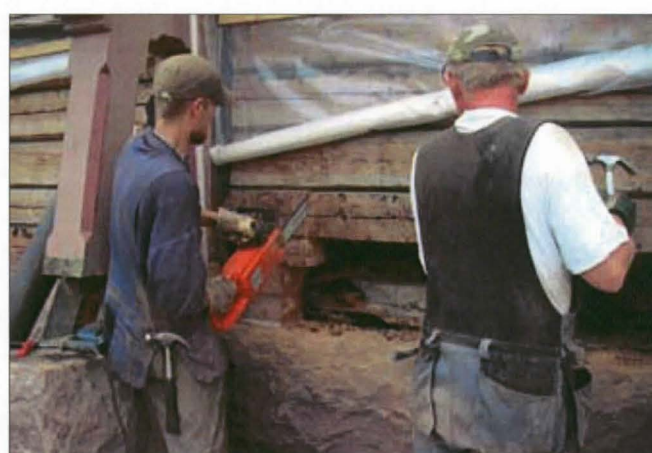
Juha Jaakonaho ja Erkki Hiltunen poistivat puoliksi lahonneet hirret. Syy näkyy vasemmalta alhaalla olevasta kuvassa.
