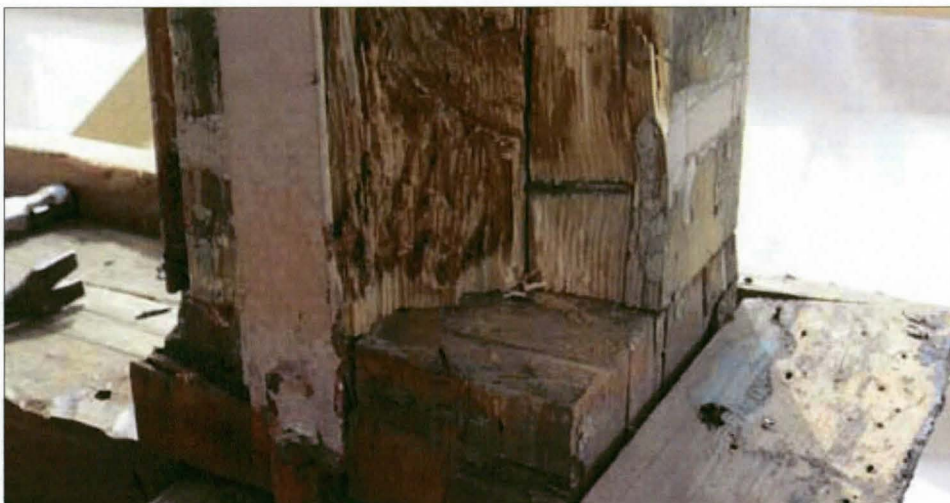
Uusittu eteläkulman pilari, joka oli kasattu liimapuumenetelmällä, oli lahonnut sisäosiltaankin. Alkuperäinen tyvi oli kuitenkin ehyt.
