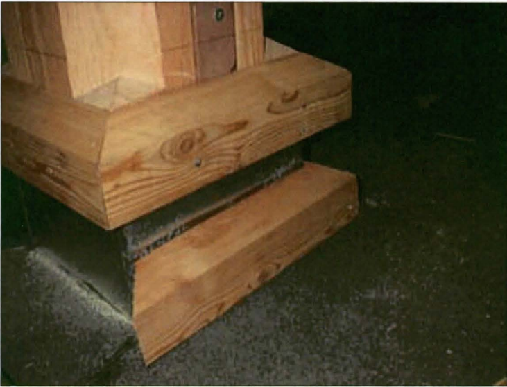
Alapään listoitukset tehtiin lehtikuusesta. Juuripellityksen yläreuna jäi ylemmän listan alle. Alempi lista kiinnitettiin nurkistaan kehäksi ja kiinnitettiin ulkosivuilta ainoastaan kahdella ruuvilla juuripellin läpi.
