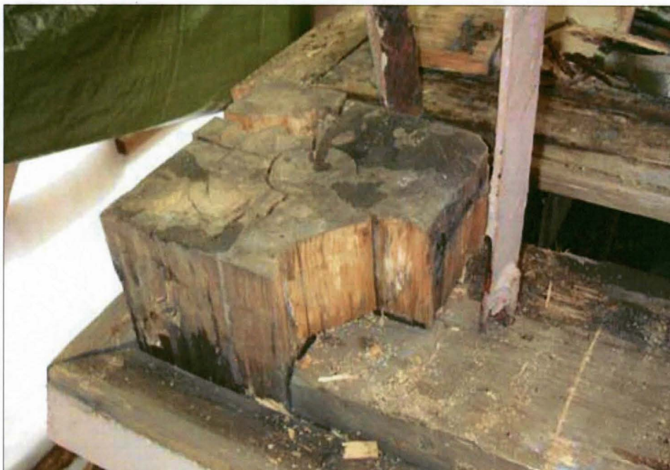
Pohjoiskulman pilarin tynkä oli pehmentynyt ja se jouduttiin lyhentämään ennen uuden asennusta.
