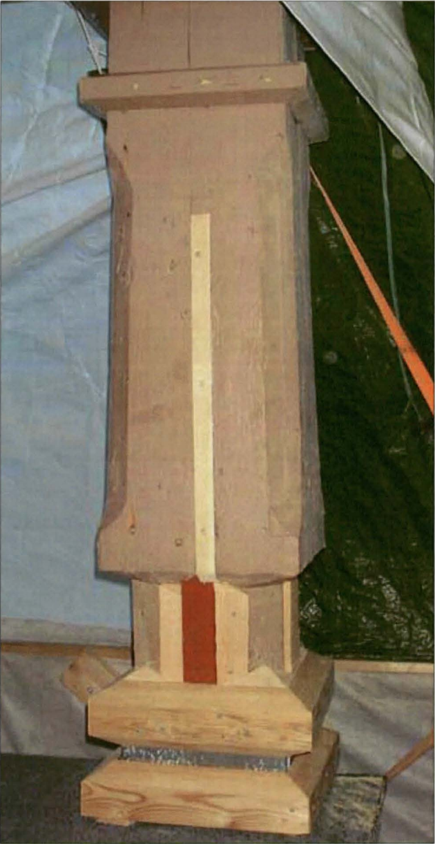
Vanhan pilarin paikattu verhous ja alapään täytelistoitukset. Verhouksen alla olevasta vanhasta pilarista on tehty mittapiirustus. Se on luovutettu seurakunnan arkistoon.
