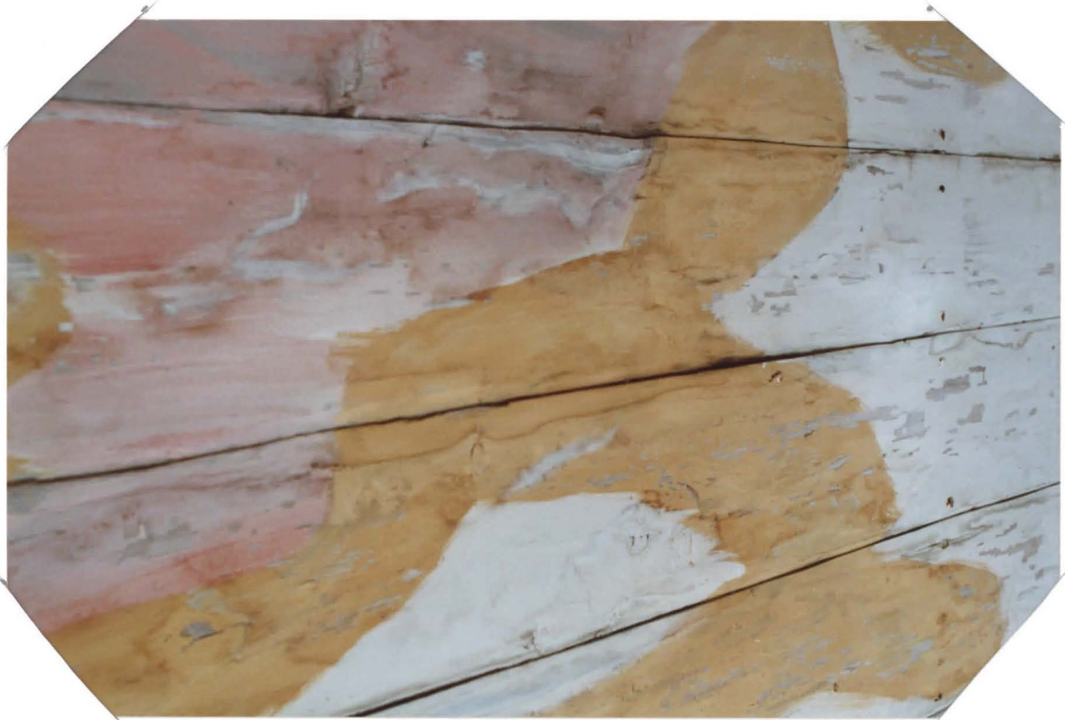
KOSTEUSVAURIOITA JA VÄRIN HILSEILYÄ KATTOMALLAUKSESSA.
