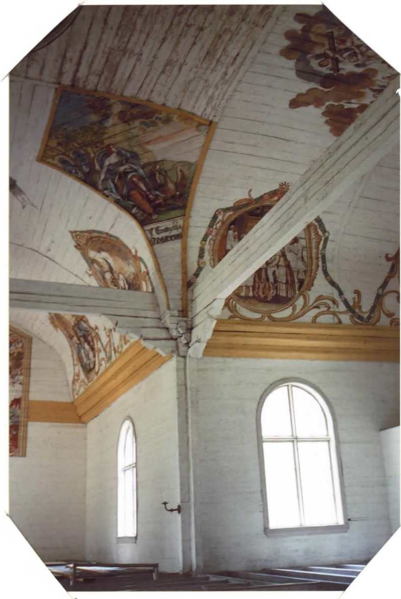
KUNNOSTETTUA JA KUNNOSTAMATONTA PINTAA
