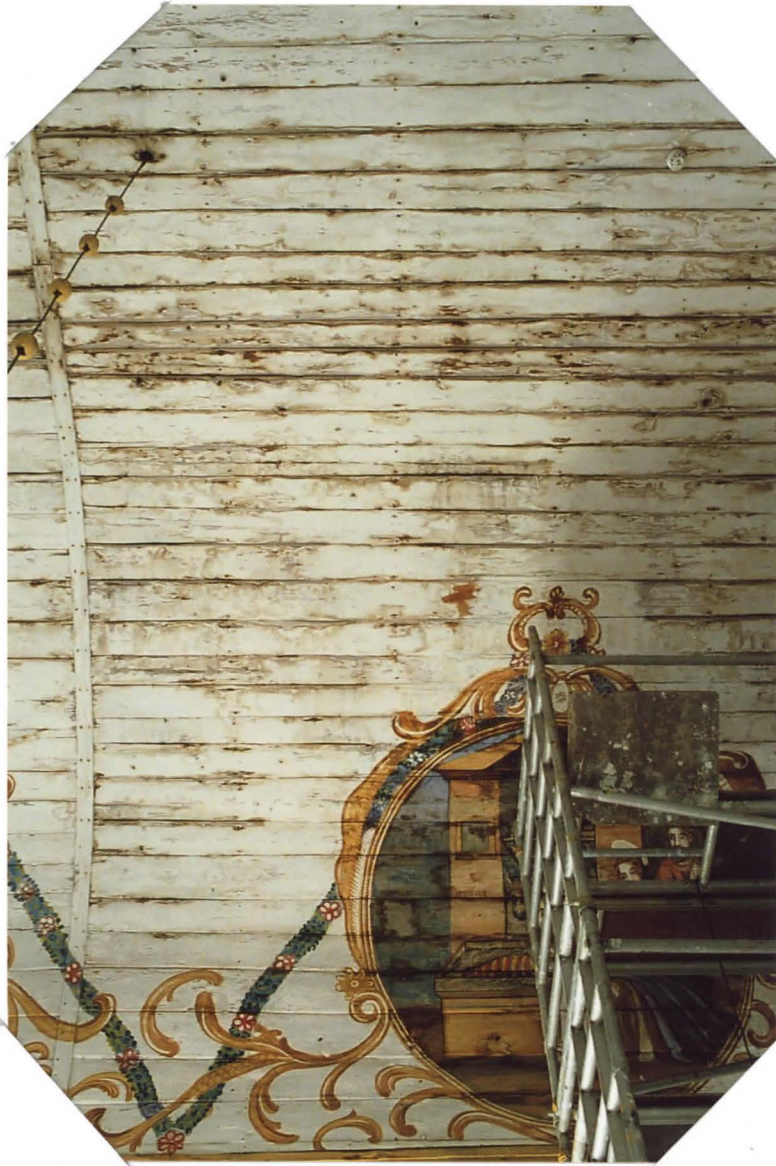
VESIVÄURIOITA ENNEN KÄYTTÖTAVARINTIA.
