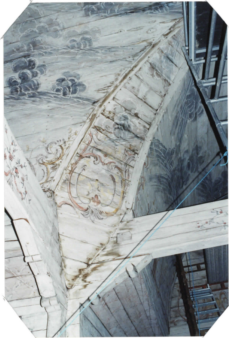
KOSTEUS VÄHÄDITÄ ETELÄ LAIPIOSSA
