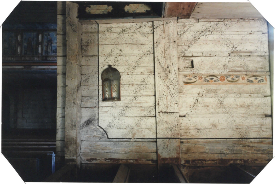
ENNEN KONSERVOINTIA- JA RESTAUROINTIA LEHTERIN ALUS. PÖHI.
