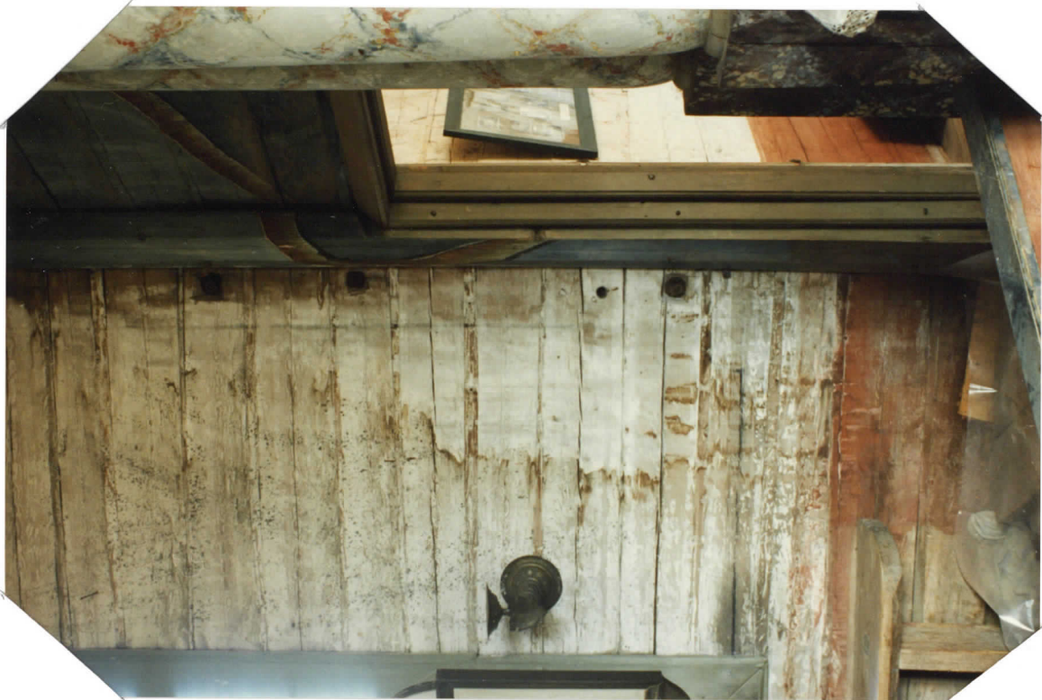
KOSTEUS VAURIOITA YM.
