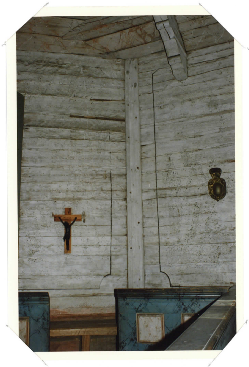
KIRKKOSALIN SEINÄÄ ENNEN PUH- DISTUSTA JA RESTAUROINTIA - PUUTTUVAH HIRREN VÄLLISTÄT TEHTY LYDEEN JA KIINNITETTY PUUTAPEILLA.
