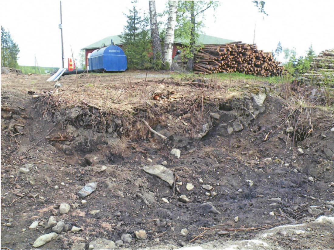
Kuva 3. Suulin luoteispuolelle koneellisesti kaivettu kaivanto. Kaivannossa erottuu nokimaata, jossa ei kuitenkaan havaittu löytöjä. Nokimaaläikkiä havaittiin muutamien kymmenien metrien etäisyydellä suulin luoteispuolella Tampereentien eteläpuolelle tehdyssä kaivannossa. Koekuoppa 1 kaivettiin taustalla näkyvän sinisen öljysäiliön oikealle puolelle koivujen lähistölle. KY 13:14. Kalle Luoto.
