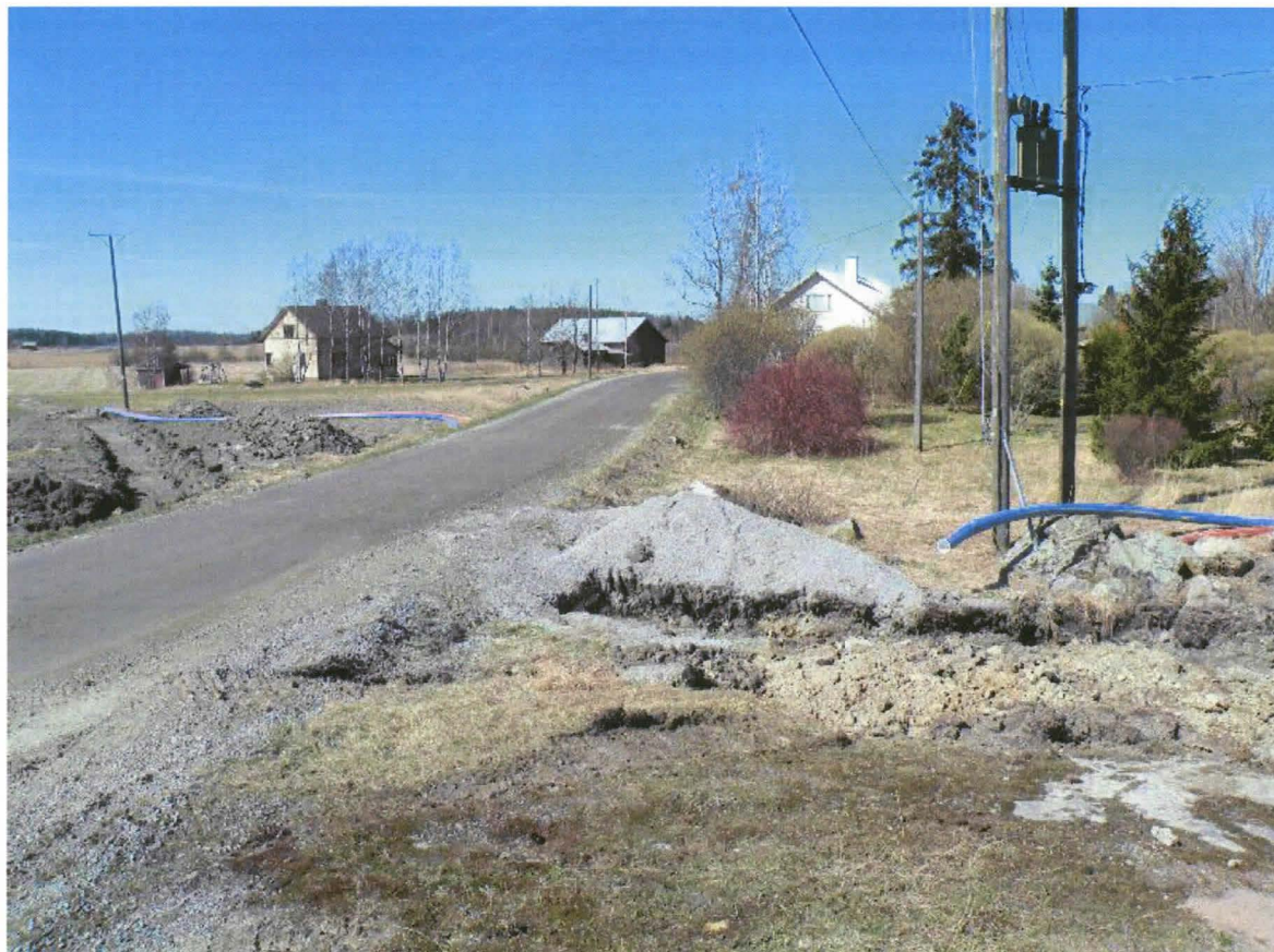
Kuva 6. Laukula. Valvottua putkilinjaa, keskellä kylän läpi kulkeva tie. 30.4.2009, Kalle Luoto. KYY 13:3.
