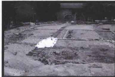
Kuva nro: 11 nega nro: 26 Aihe: Teollisuuspihan kiveys ja radanpohjia. Kuvan keskellä näkyvä osa radanpohjaa on suojattu suodatinkankaalla. Taustalla pannuhuone. Suunta: E pvm: 9.9.2010
