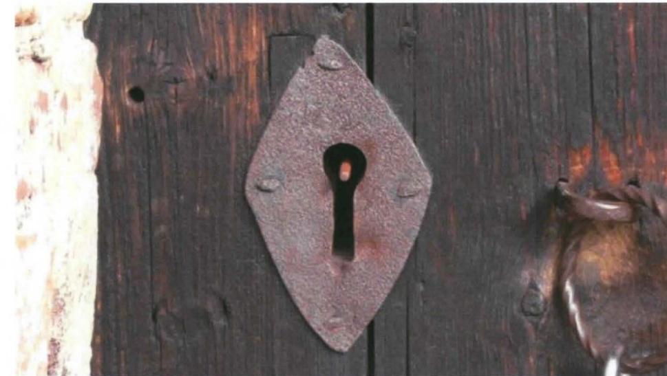
Asehuoneen lukon hela, ENNEN KÄSITTELYÄ
