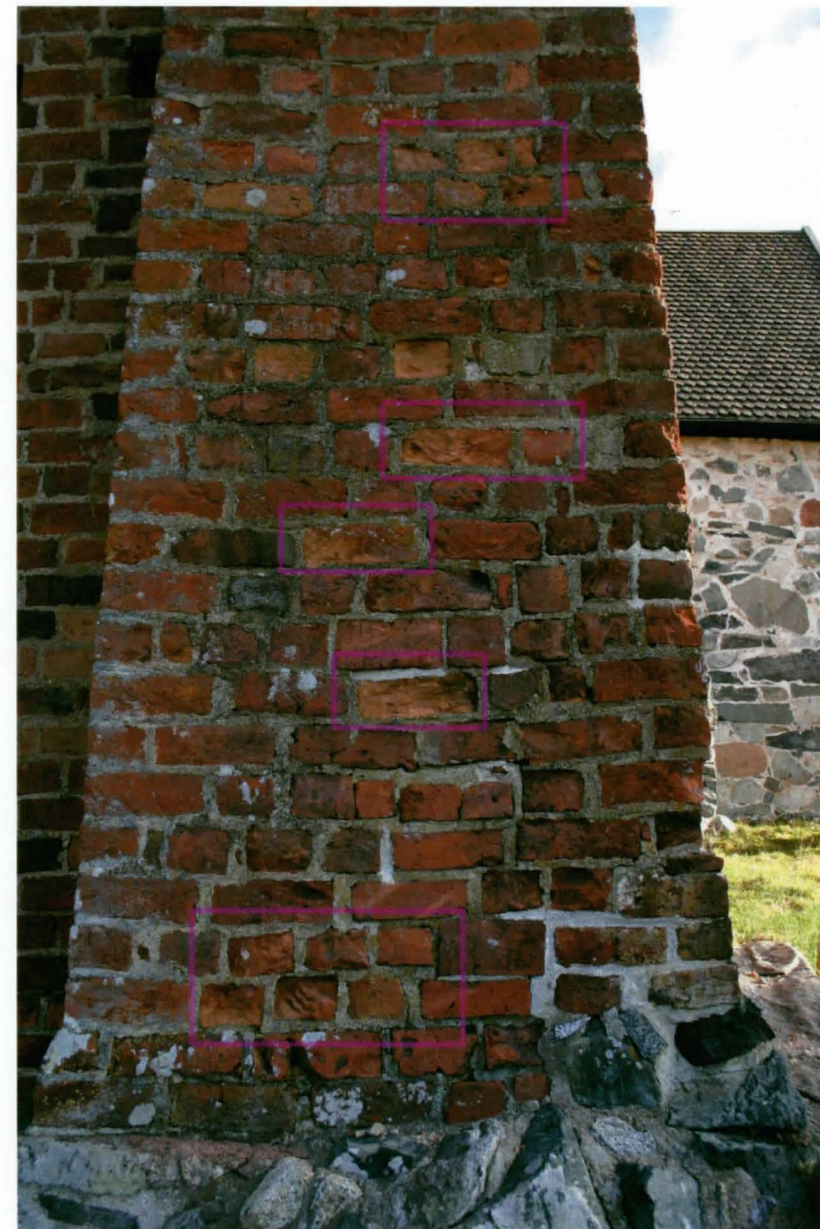
K1-tukipilarin länsipuolen tiilivauriot
