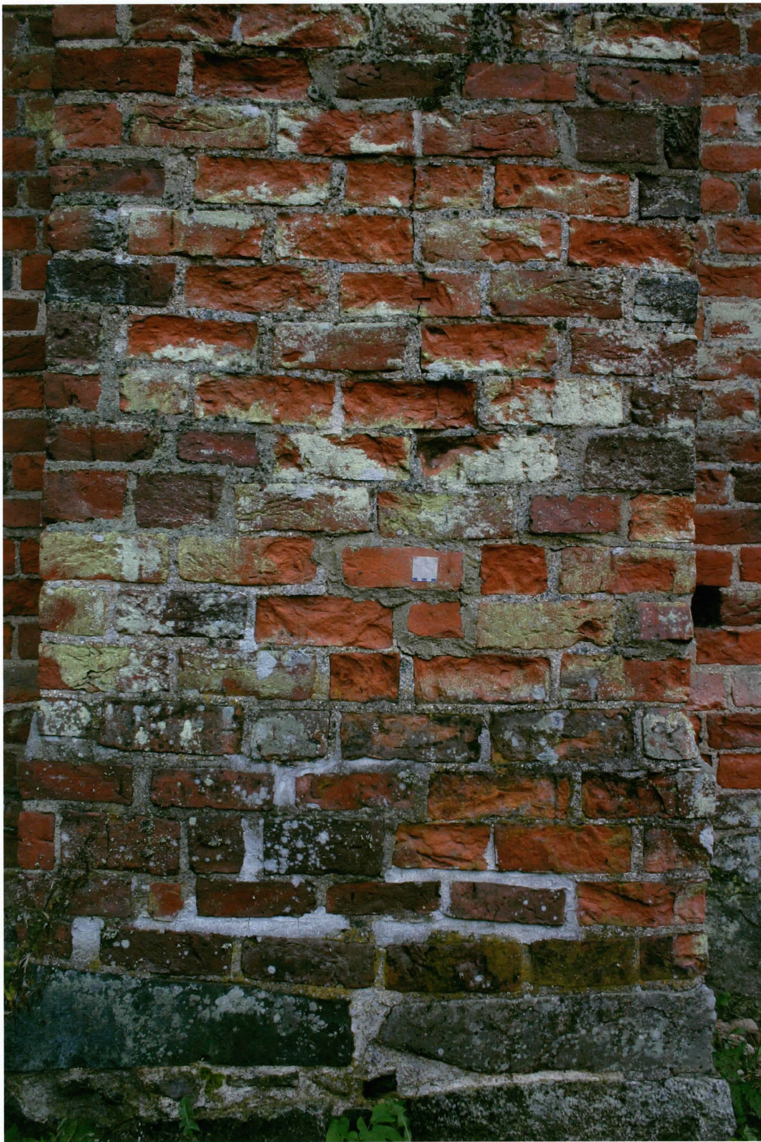
Pohjoisseinän K10-tukipilarin pohjoispuolen vaurioituneita tiiliä.
