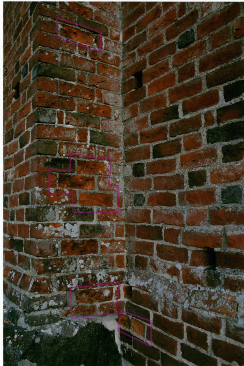
K11-tukipilarin ja länsiseinän nurkassa olevat tiilivauriot
