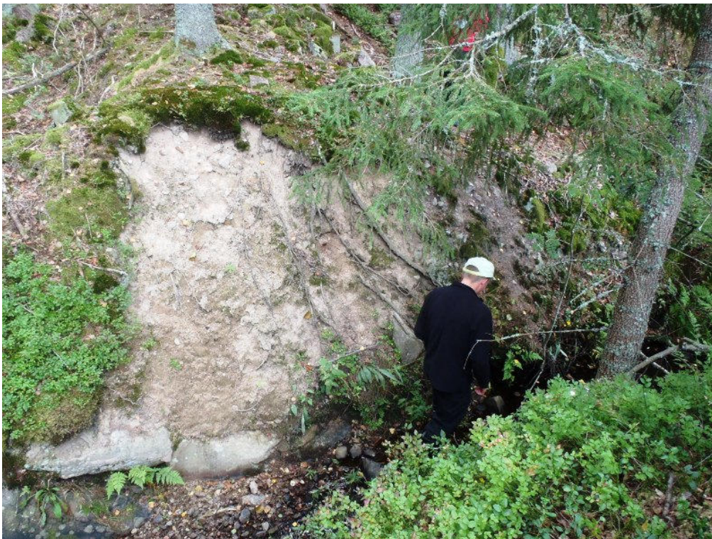
Kuva: Patovallien aukko puronuomassa. Puurakenteet ovat hävinneet tyystin. 29.8.2013. Jouni Taivainen.
