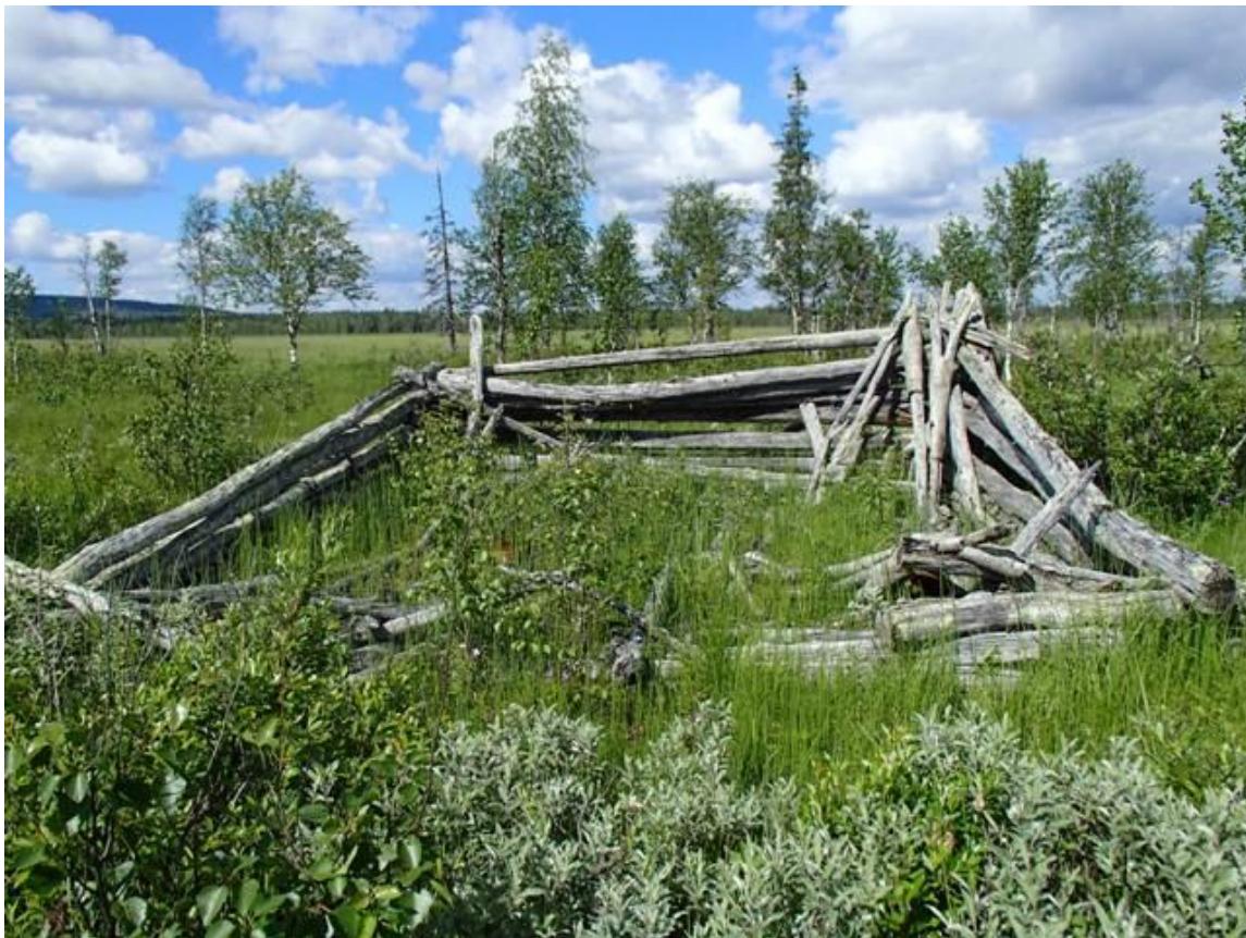
Ladon ovenpuoleinen seinä on romahtanut, kuvattu luoteeseen.
