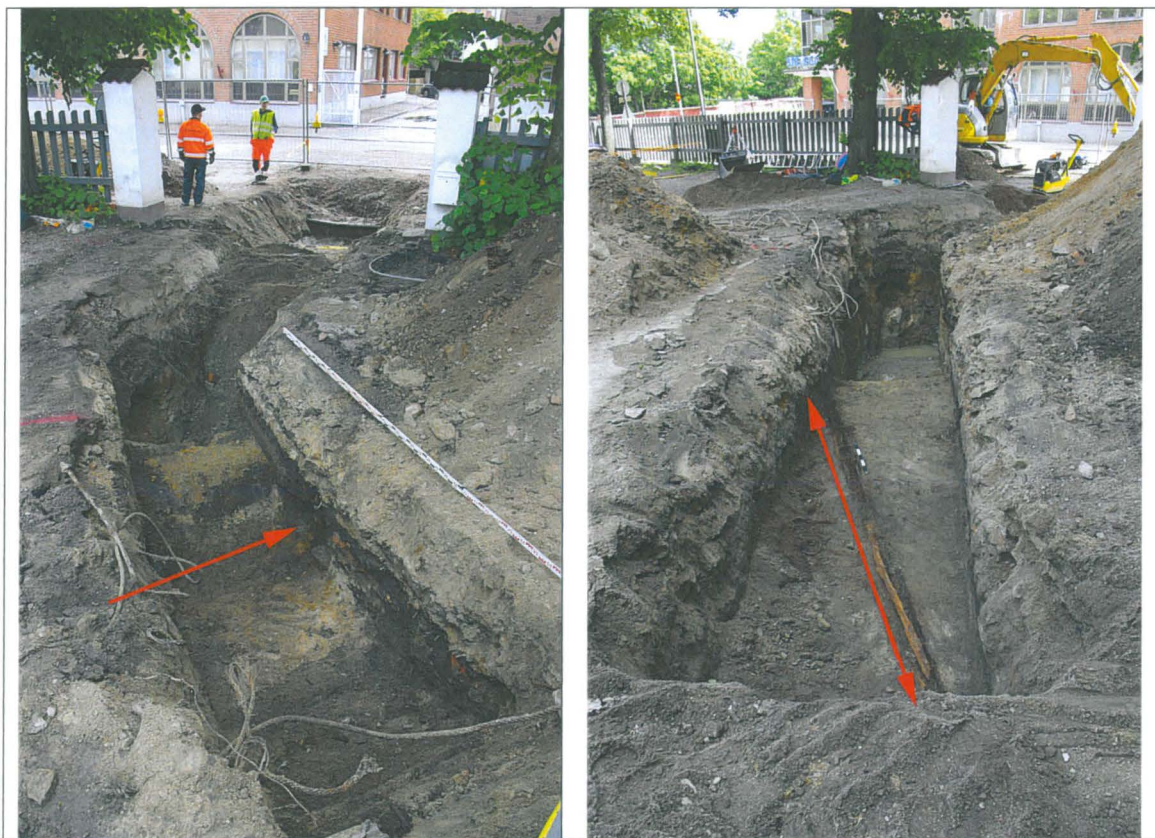
Kuvat 11–12: Vasemmalla viemärioja VO1 jo osittain peitettynä ja VO2 kesken kaivutöitä. Rakenteen R1 kulku on merkitty kuvaan punaisella nuolella. Taustalla P. Torvinen (vas.) ja E. Coert (Sakka Oy). W. Oikealla oja VO2:n länsipäästä paljastunut puurakenne R2 esiin kaivettuna ennen sen poistamista. W. Kuvat: KyM/M. Kykyri.
