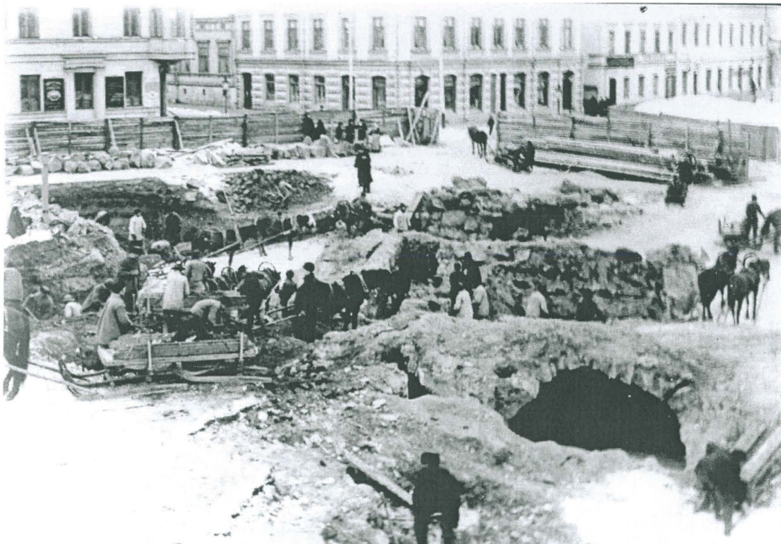
Kuvio 7. Yleiskuva kaakosta kaupunginkirjaston työmaasta 1902. Oikeassa alakulmassa huone 4. Kuormat vedettiin reellä pitkin rampeja, jotka kulkivat keskeltä rakennusjännöksen SW-osaa ja SW-osan ja NE-osan välistä.
