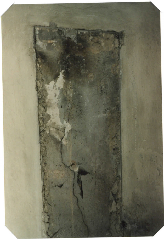
urkuparven penkin irroittamisen jälkeen tuli esiin harmaa kalkkiväri
