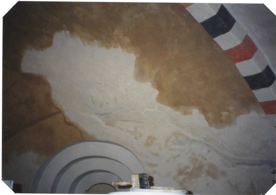
etelä-seinän ylikalkkaamaton osa
