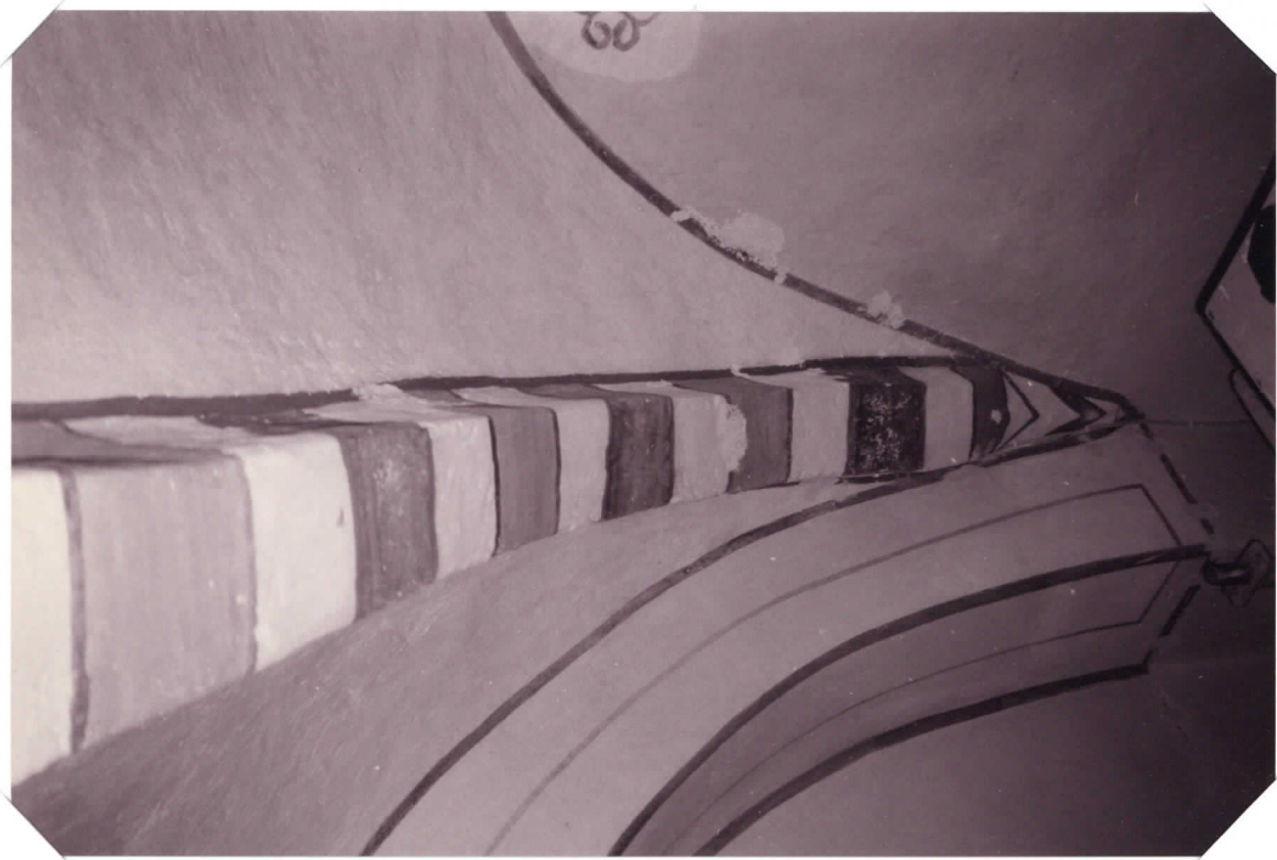
vaurioitunutta pintaa kaakkoisnurkassa
