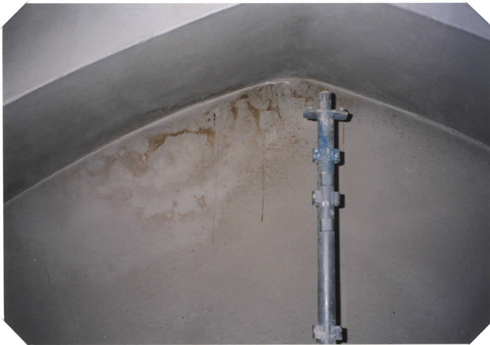
kosteusvaurio eteläisen sisäänkäynnin yläpuolella, alakuvassa eristettynä
