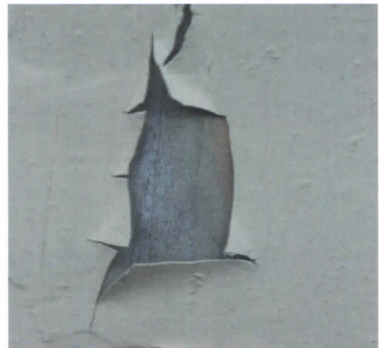
KUVA 8. Pilasterin kuoriutuvaa maalia
