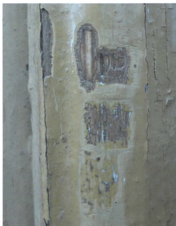
KUVA 5. Seinälaudoituksen pystylistan värejä
