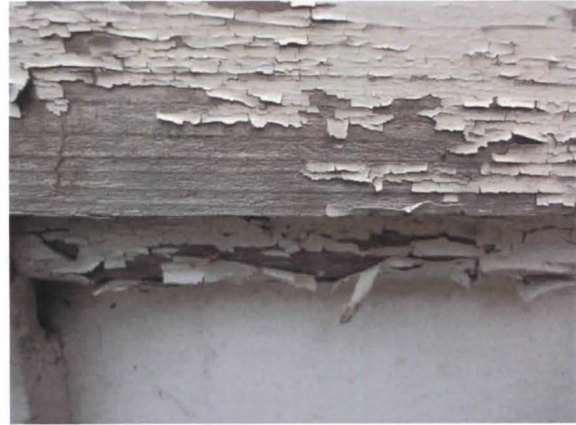
KUVA 14. Ikkunan hilseilevää maalipintaa
