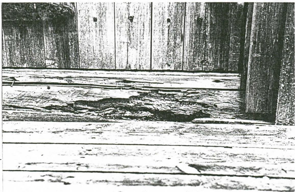
43. LAHO - JA HYÖN- TEISVAURIO LOUNAISSEINÄN OVIEN ALLA
