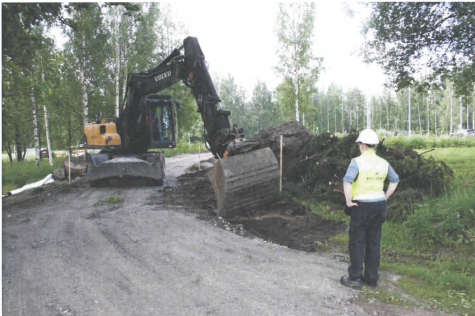
Kuva 1. Uuden tielinjan luoteispäähän kaivettiin oja viemäröinnille. Tuija Väisänen valvoo kaivutyötä. Kuvattu itään. Kuva: Satu Koivisto/ARKE (AKDG 3711:14).
