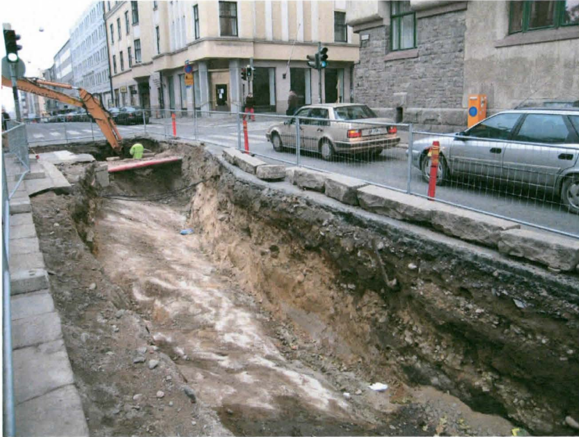
Kuva 15. Kaivannon länsipää ennen Annankadun risteystä. Kaivanto siirtyy hiukan kesemmälle katualuetta. Kuvaussuunta W. 4.11.2005.
