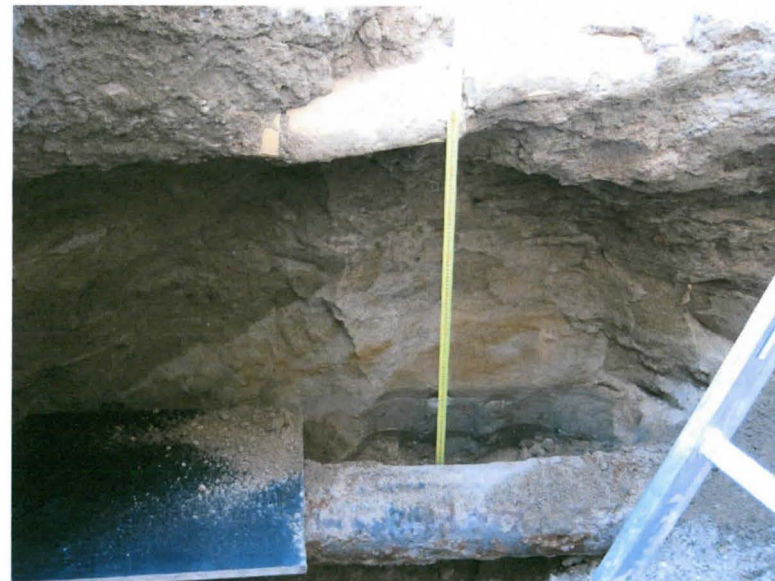
Kuva 6. Lähikuva edellisestä tilanteesta. Kaapelin alla oli pian luonnollinen kellertävä hiekka ja sen alla putken korkeudella harmaa ja tumma siltti/savi. Kuvaussuunta NW. 30.3.2011.
