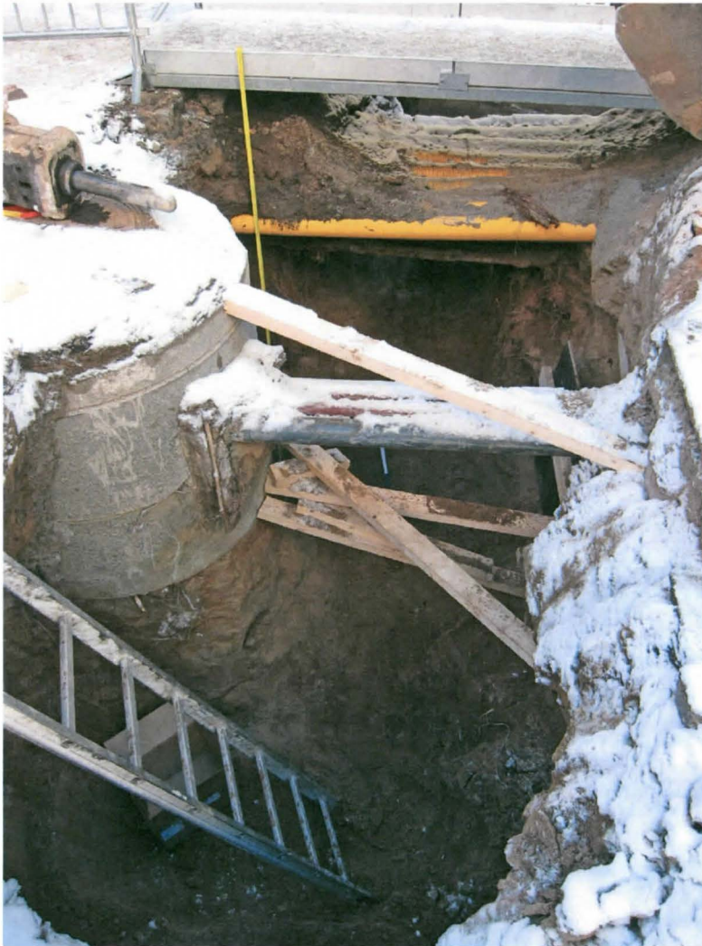
Kuva 1. Kuvassa näkyy kaivettu putkikaivanto kokonaisuudessaan. Vasemmalla itäseinässä on pyöreä kaapelikaivo, jonka alla on puhdasta hiekkaa. Keltaisten kaapeleiden takana on rakennuksen betoninen perustus. Kuvaussuunta SE. 30.3.2011.
