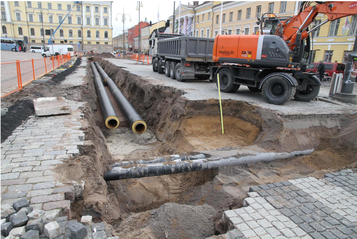
Kuva 36. 9.10.2012 uudet kaukolämpöputket on asennettu asuinkorttelin puolelle. Kuvan alareunassa Sofiankadun linjalla oleva suojatie ja hautausmaa on kuvaajan takana. Kuvaussuunta itään. Heini Hämäläinen/HKM
