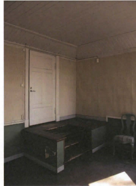
Kuva 1. Vesivuotokohta oli verannan sisäoven yläpuolella ja oven oikealla puolella viistossa paneelikatossa.
