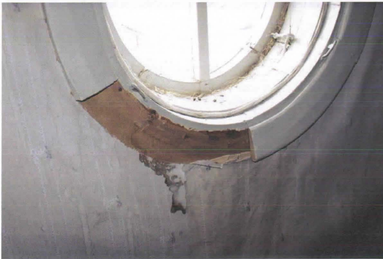
Kuva 15. Varaston ikkunan vuorilista irrotettu.
