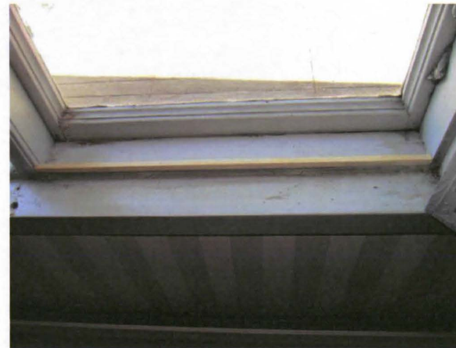
Kuva 55. Lisähuulloslista yläsalin ikkunassa.
