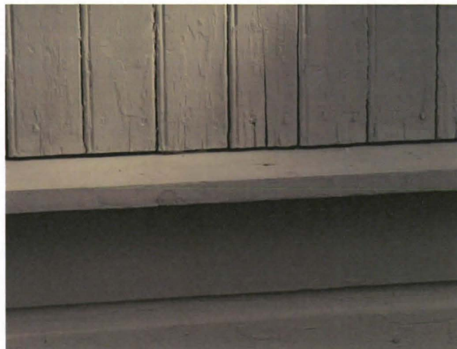
Kuva 8. Ulkoseinän rako, josta vesi todennäköisesti on kulkeutunut seinärakenteisiin.
