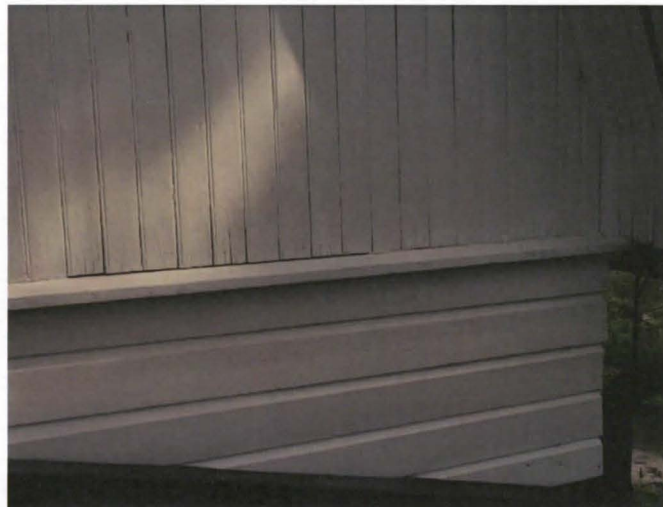
Kuva 7. Kerroslistan päällä oli paikoitellen rako pystypaneelien alla.
