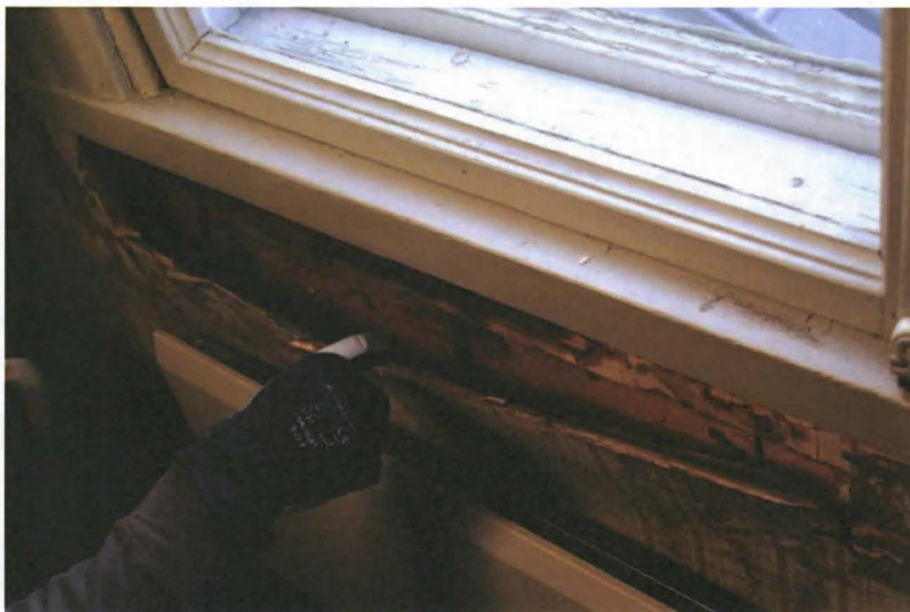
Kuva 11. Ruusukamarin ikkunan vuorilista irrotettu.
