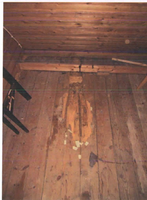
kuva 56. Lattian vanha hyönteisvaurio ennen toimenpiteitä.
