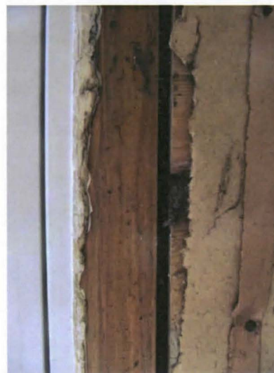
Kuva 14. Tätien huoneen irrotetun sivuvuorilistan alla oli rako johon laitettiin pellavarivettä.
