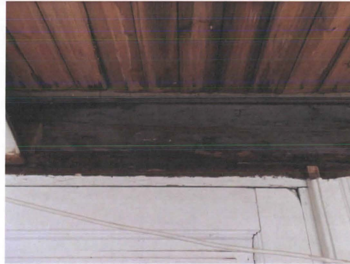
Kuva 4. Lahonnut ja homeinen osa laudasta poistettiin.
