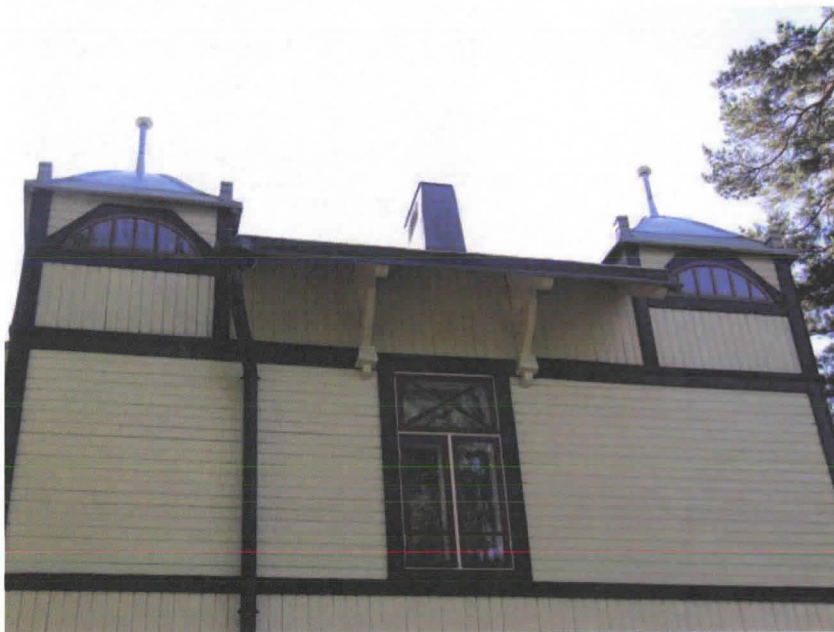
Kuva 62. Tornin itäpäädyn ja sisäpihan puoleisten ikkunoiden yläreunat kallistuivat ulospäin.
