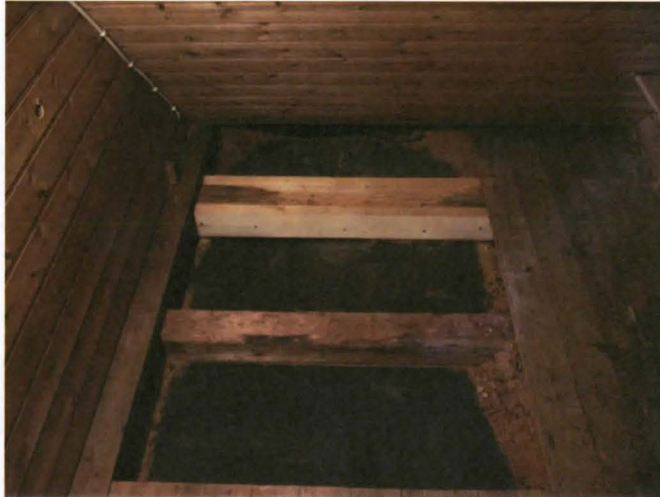
Kuva 58. Vaurioitunut lattiapalkki tuettiin molemmin puolin.
