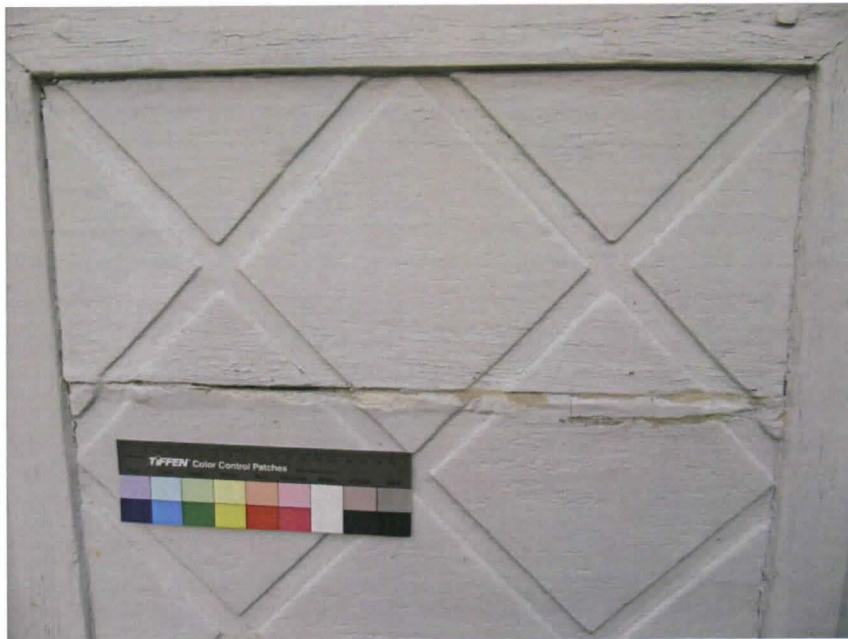
Kuva 10. Osittain kitattu oven halkeama.
