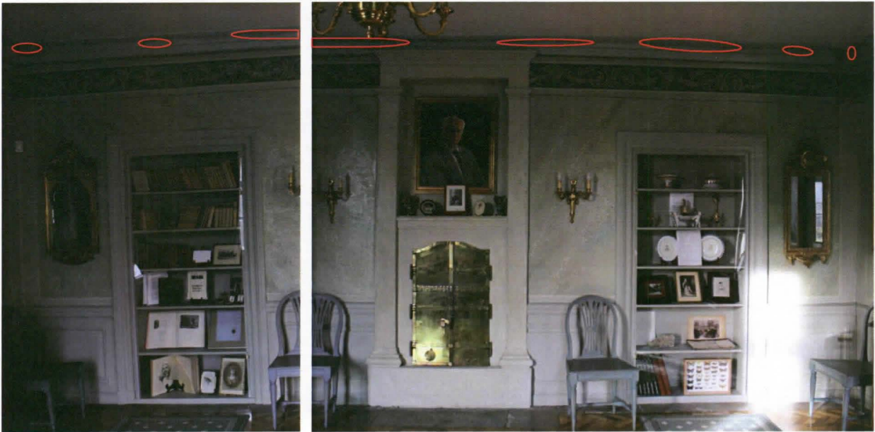
Kuvat 25 ja 26 pohjoisen seinästä ja vauriokohdista. (Kuvat L. Niinipuu)
