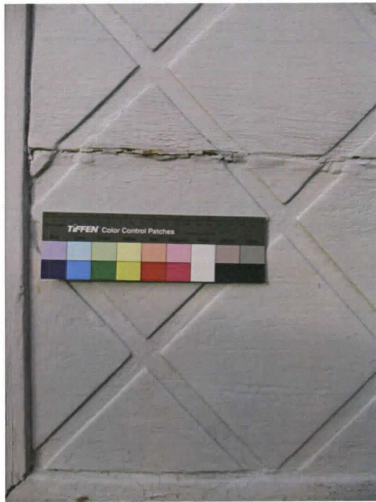
Kuva 9. Oven halkeama ennen restaurointia
