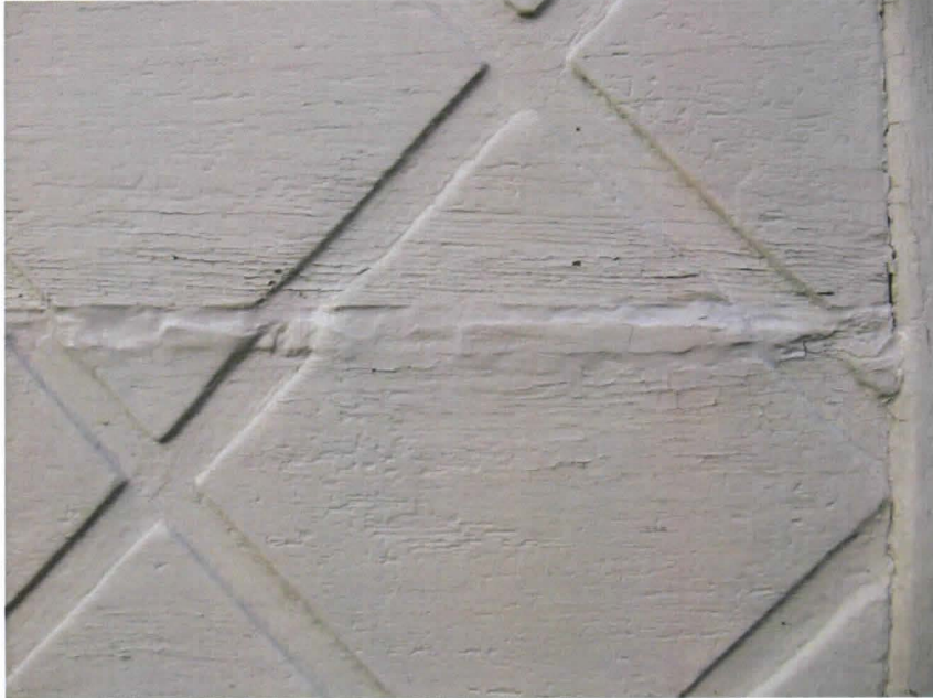
Kuva 11. Kitattu ja maalattu oven halkeama jossa näkyy vanhat korjaukset.
