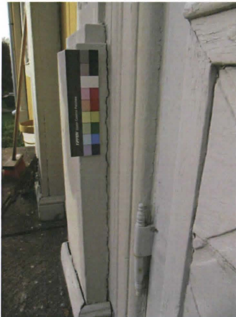
Kuva 2. Pilasteri sivusta ennen halkeaman paikkausta.
