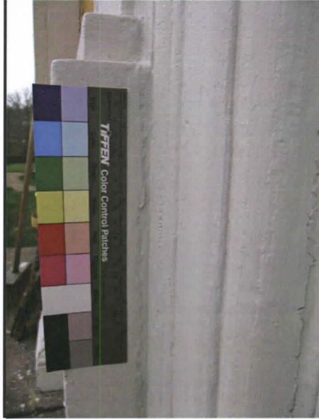
Kuva 6. Pilasterin halkeama restauroinnin jälkeen.
