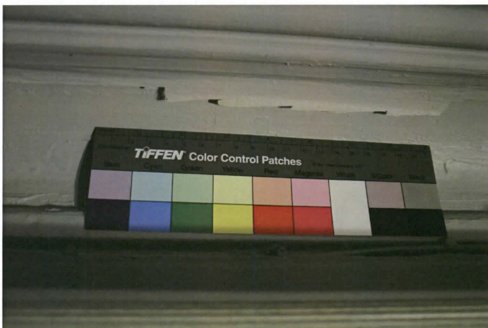
Kuva 21. Eteläseinän vasemmanpuoleisen ikkunan yläpuolella olevaa vauriota. (Kuva L. Niinipuu)
