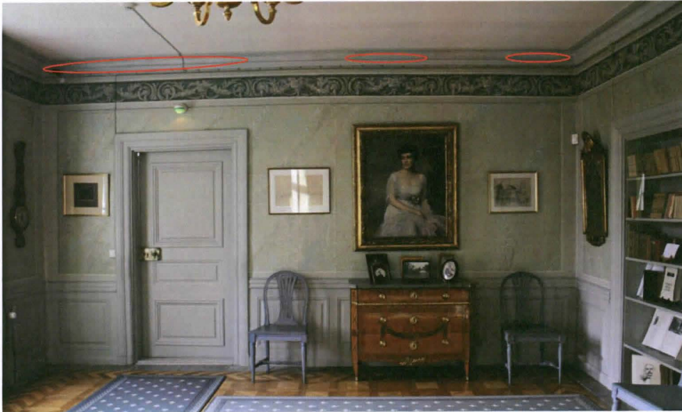
Kuva 24. Länsipuolen seinän vauriokohdat. (Kuva L. Niinipuu)
