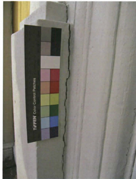
Kuva 3. Pilasterin halkeama läheltä. Kuvaaja: Essi Seppälä
