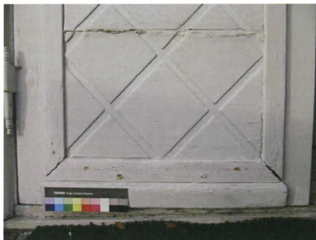
Kuva 8. Oven alaosa ennen restaurointia. Kuvaaja: Essi Seppälä
