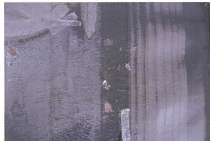
Oikean yläreunan kangaspinnan laskostumista ja irtoavia maalikerroksia. Kuvassa myös Nylundin pintasuojauksia.
