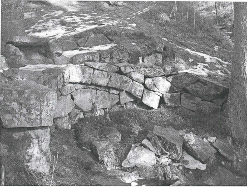
Kuva 3. Rakennekokonaisuus 1. Kivirakenteesta murtunutta kiveystä rakenteen edessä lähteen veden purkautumisreitillä.
