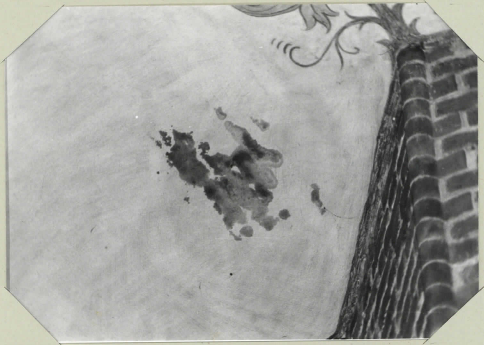
kosteusvaurio holviston itäosassa 6.6-76
