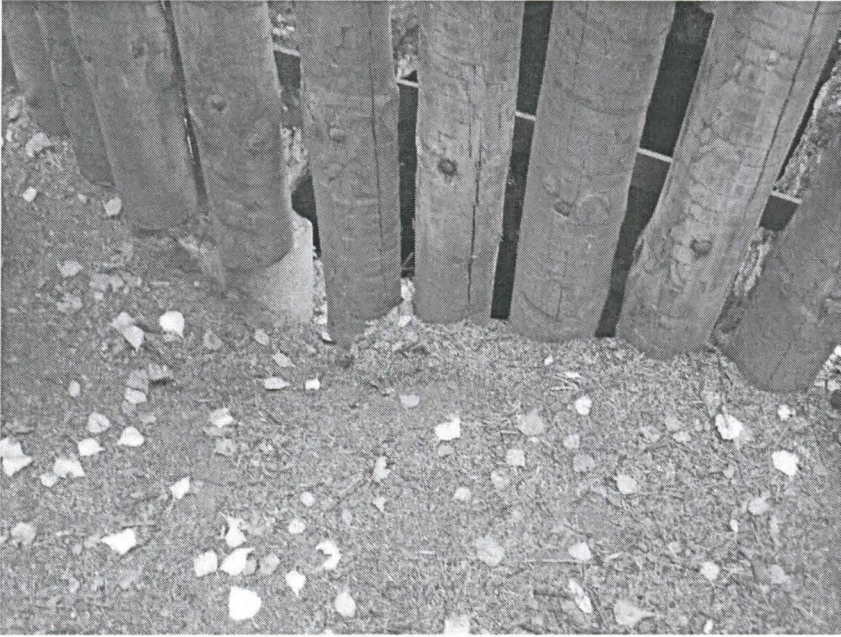
Kuva 11. Alkava eroosio. Polun hiekkaisa täytemateriaali valunut turva-aidan alta ja paikalle syntymässä vaarallinen, jopa pienen lapsen läpipäästävä kolo. Suositellaan pikakorjausta suurehkoilla kivillä, joiden väliin ja päälle karkea kivimurska tai hienohko hake. (Ks. myös kuva 10).
