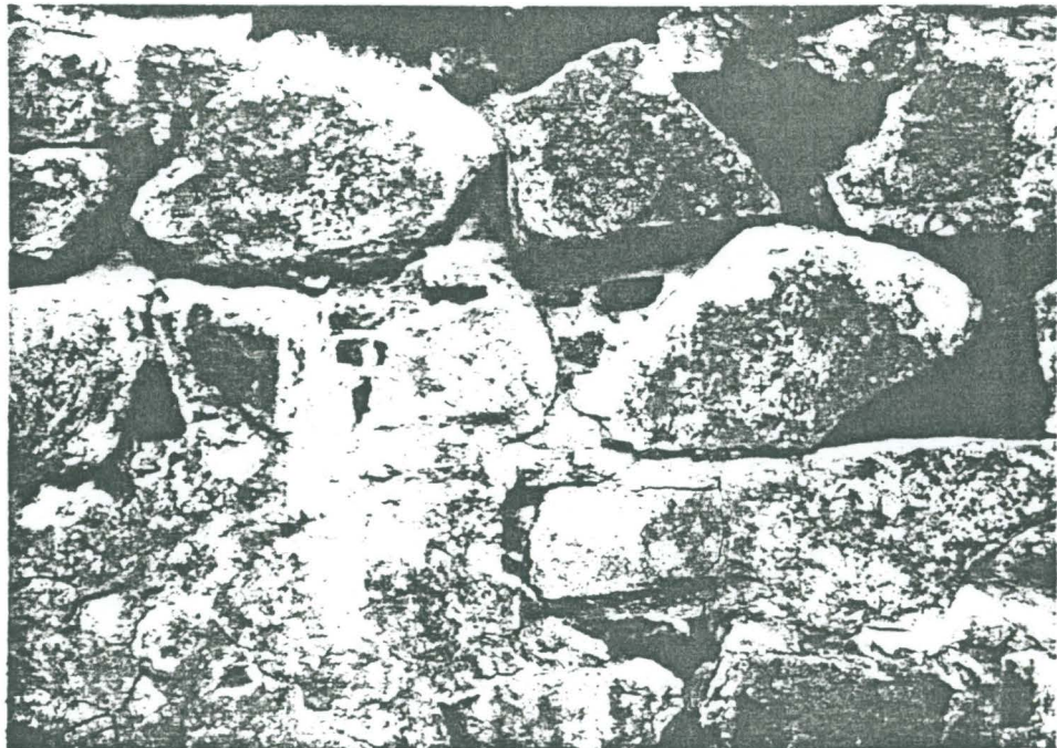
O-huoneen eteläinen ulko- seinä, alue I. Tiilen päitä kivien 21, 26 ja 28 välissä.
