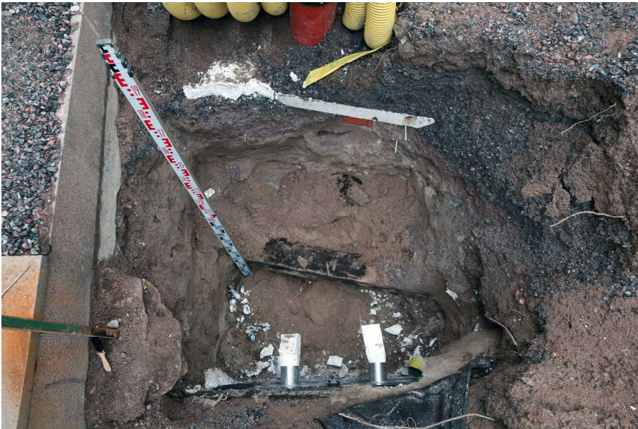
Kuva 135. Edellinen kohta. Kuvan alareunassa näkyy kaupungintalon alla olevan autotallin betoniseinä. Seinään on tehty kaksi reikää linjoja varten. Latan takana on veistetty hirsi, jonka alla oli toinen. Ne liittyvät alueen rakentamiseen 1980-luvulla. Kuvaus päältä, kuvaussuunta N. 21.10.2014.
