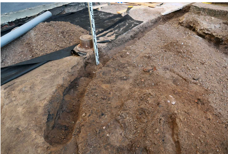
Kuva 24. Pihan koilliskulmasta kaivettiin matala kaivanto sadevesiviemäriputkea varten kohti uusia sadevesikaivoja. Kuvasuunta NE. 19.9.2014.
