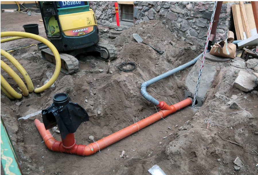
Kuva 128. Uusi sadevesiviemäriputkien järjestelmä, jossa vedet ohjataan vanhaan jätevesikaivoon. Alkuperäistä suunnitelmaa putkilinjojen viemistä eteläisen autotallin seinän läpi ei voitu toteuttaa teknisten ongelmien takia. Kuvaussuunta NE. 3.10.2014.
