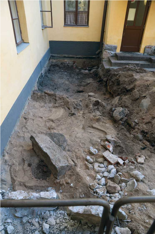
Kuva 18. Pihan pohjoisosassa. Edustalla näkyy porraskaiteen takana rikottua tasonostimen betoniperustaa ja keskellä uudehkoa hiekkakerrosta. Taustalla on alempana sekoittunut hiekkakerros rakennusjätteineen. Kuvaussuunta E. 15.9.2014.
