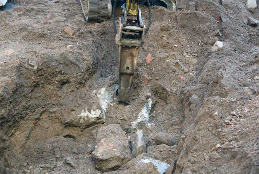
Kuva 107. Keskilinjan kaivannosta tuli pihan entisen kulkuluiskan pohjoispään kohdalla isoja betonimöykkyjä ja iso kivi, joiden yläpuolella oli vähemmän rakennusjätettä sisältävä tummempi kerros. 1980-luvun rakentamiseen liittyvät betonit ja kivi olivat hienommassa hiekassa. Kuvaussuunta S. 24.9.2014.
