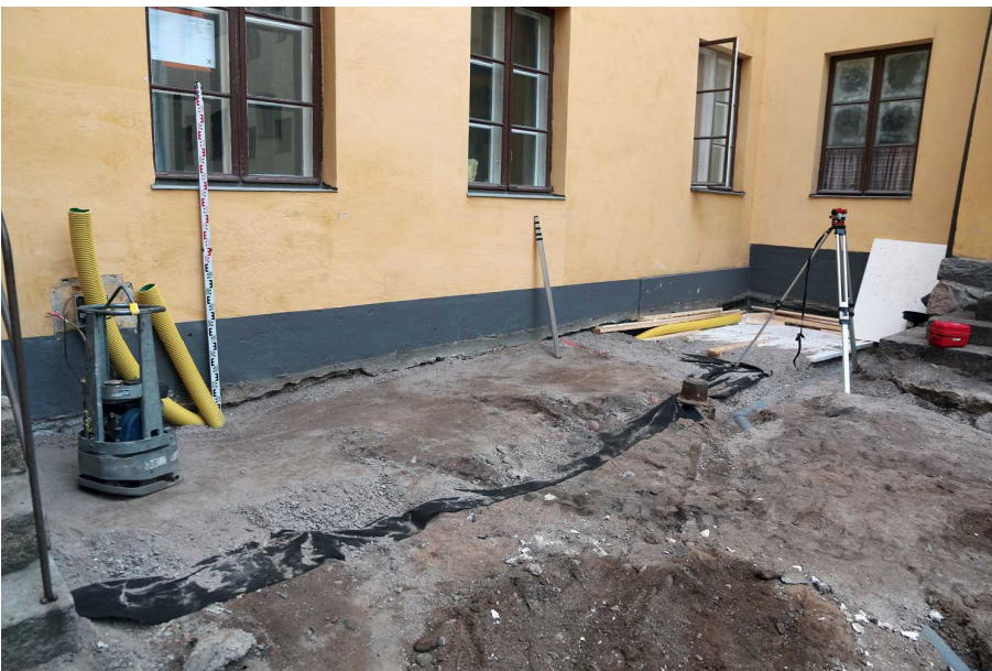
Kuva 28. Pihan pohjoisosaan on laitettu pohjakangas ja soraa. Koilliskulmassa ollaan valmistelemaan avonaisen ikkunan eteen tulevan oviaukon portaikon pohjabetonointia. Kuvaussuunta NE. 22.9.2014.
