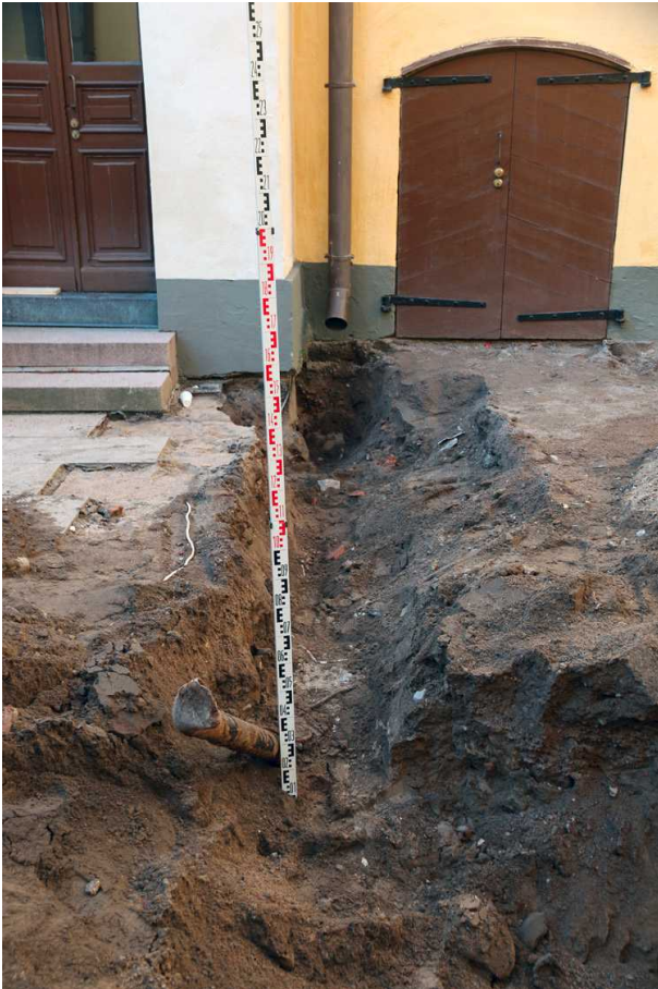
Kuva 119. Edellinen tilanne. Edessä näkyy irrallinen metallinen kaasuputken katkelma. Kaasuputki on sijainnut karttojen perusteella huomattavasti pohjoisempänä. Kuvaussuunta W. 24.9.2014.
