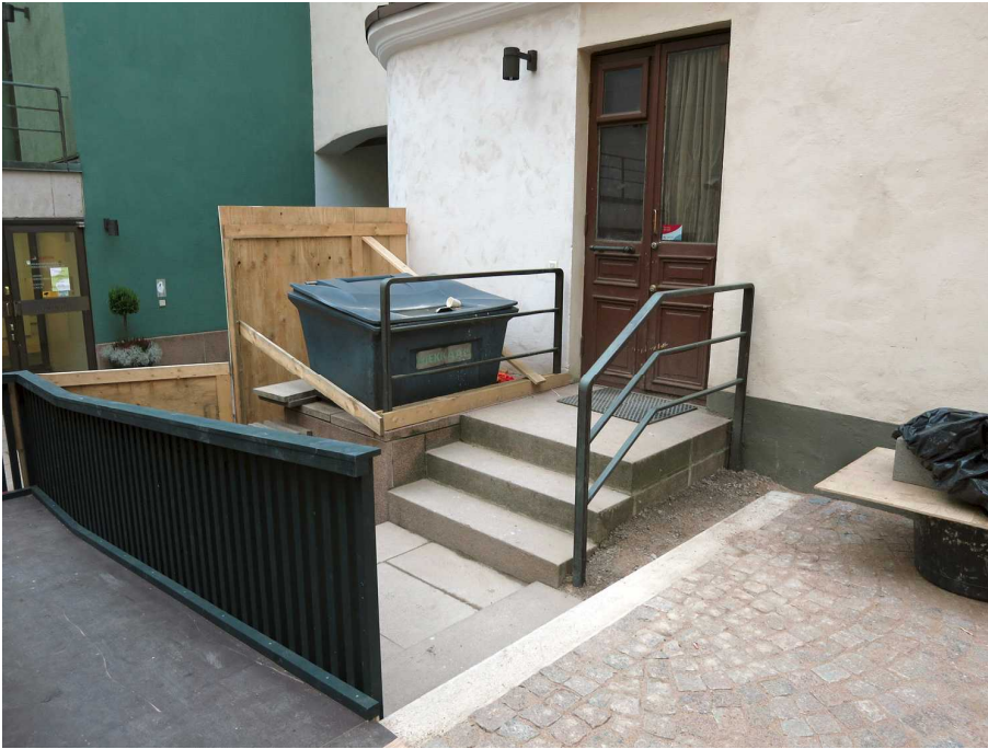
Kuva 142. Uusi pihakiveys loppui ennen länsiseinän eteläisintä oviaukkoa. Uusi kiveys on 20 cm korkeammalla kuin vanha laattakiveys portaiden pohjoispuolella. Kuvaussuunta SW. 20.11.2014.
