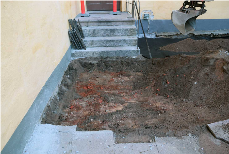
Kuva 22. Edellinen kohta. Todennäköisesti melko uusi sekoittunut hiekkakerros rakennusjätteineen vahvistui syvemmälle kaivettaessa. Taustalla pihan pohjoisosassa pihan pohjarakenteiden takia kaivettu syvyys on tavoitettu. Alimmaksi on laitettu kangas, jonka päälle laitetaan soraa. Kuvaussuunta N. 19.9.2014.
