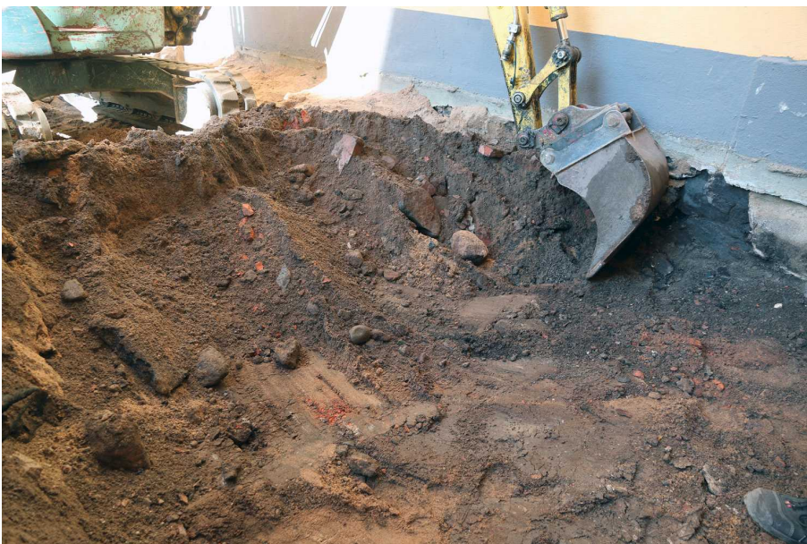
Kuva 17. Pihan pohjoisosaa edellisen kohdan länsipuolella Helleniuksen ja Burtzin rakennusten eteläseinän luona kaivetaan koneellisesti. Siellä oli ylempänä uudempi hiekkakerros ja alempana sekoitettua hiekkaa ja rakennusjätettä. Kuvaussuunta NW. 15.9.
