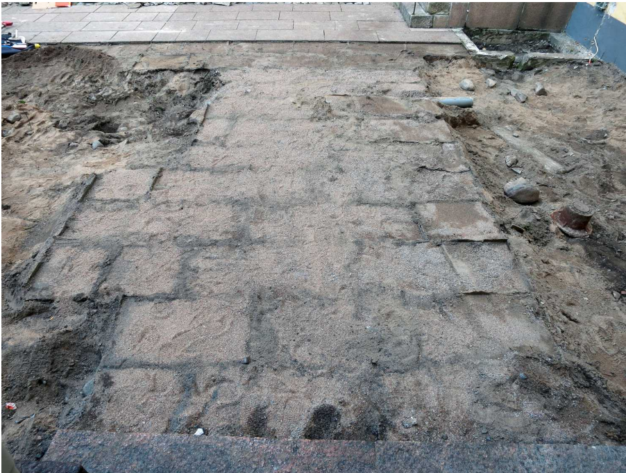
Kuva 30. Pihan itäpuolella sijaitsevaan Sumppuun johtaneelta laattapäällysteiseltä käytävältä ja jäteastioiden kohdalta on poistettu laattakivet. Kuvaussuunta W. 12.9.2014.
