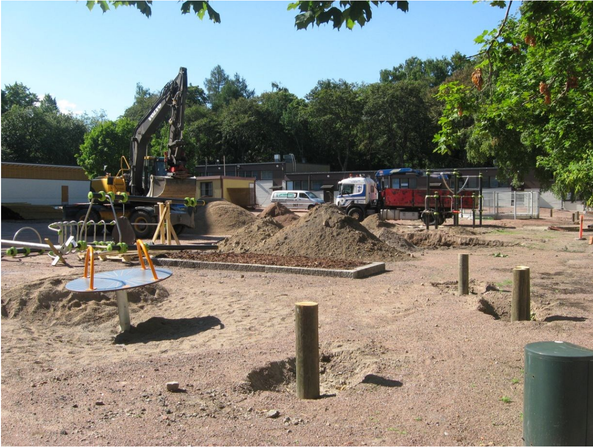
Kuva 2: Keskuskoulun pihan saneeraustyöt käynnissä kesällä 2011. Kolme vuotta myöhemmin alueella kaivettiin viemäriä kuvan keskellä näkyvän kuorma-auton edustalta sen takana näkyvän pyöreän peliarenan ohitse Opistokadulle. Katu kulkee kuva-alan ulkopuolella oikealla. N. Kuva: KyM/M. Kykyri.
