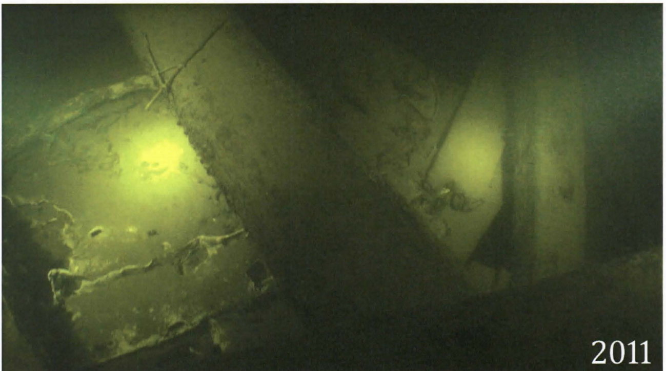
Kuva 9. Litistynyt metalliesine alas romahtaneen perähytin kansipalkin alla.
