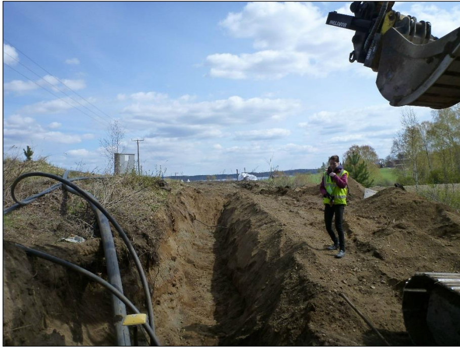
Kaivanto lopullisessa syvyydessä. Taustalla näkyvät muinaisjäännösalueella sijaitsevat kaivo, sekä sähkökeskus, joiden kaapelit risteävät nyt kaivetussa kaivannossa. Kuvattu itään.
