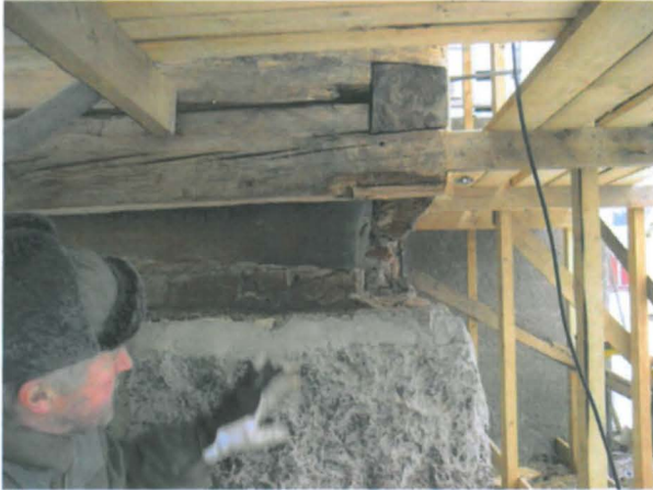
Olli Cavén MV/2008 Nurkan alimmaisets hirsikerrat ovat lahonneet. Tiivistä hirteen takana oli bitumihuopa ja betonivalu.
