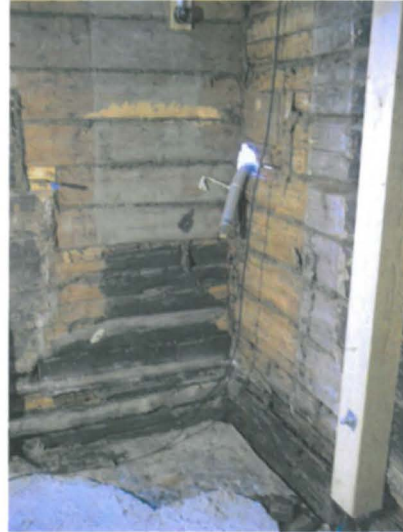
Olli Cavén MV/2008 Lahovaurioita ja paikkauksia saman nurkan sisäpuolella.
