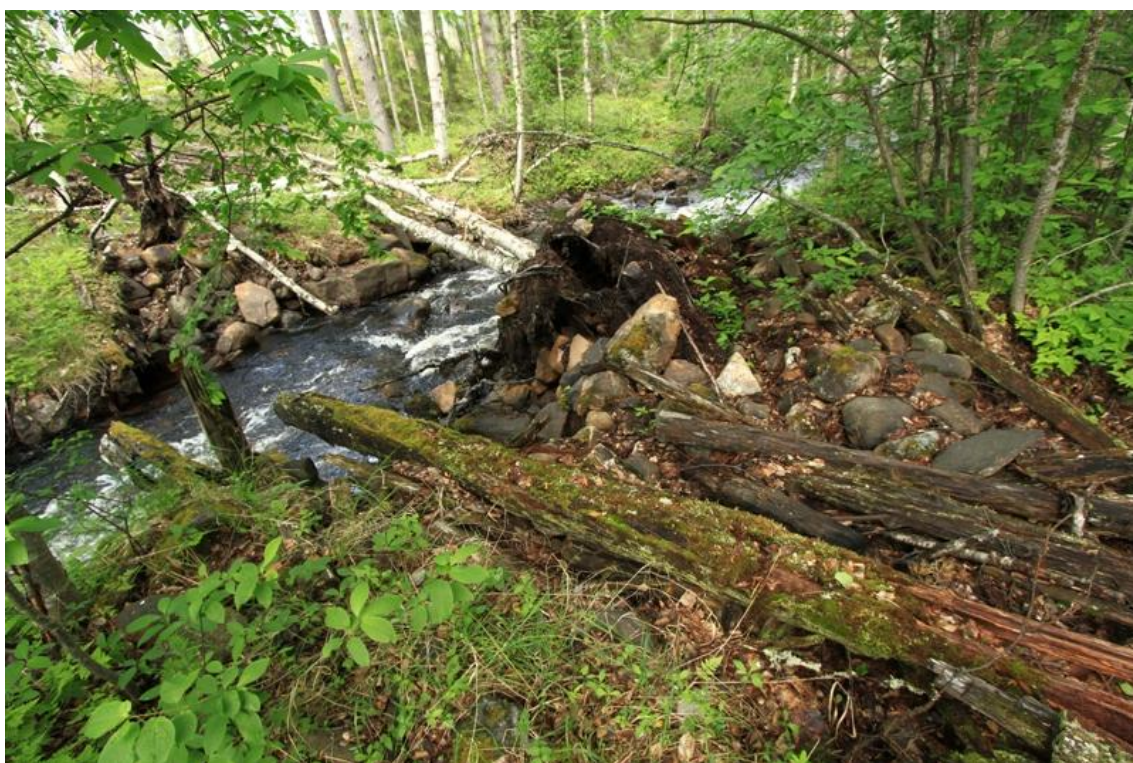
Kuva 170043_1. Tammen rikottua arkkurakennetta. Kuvattu etelästä.
