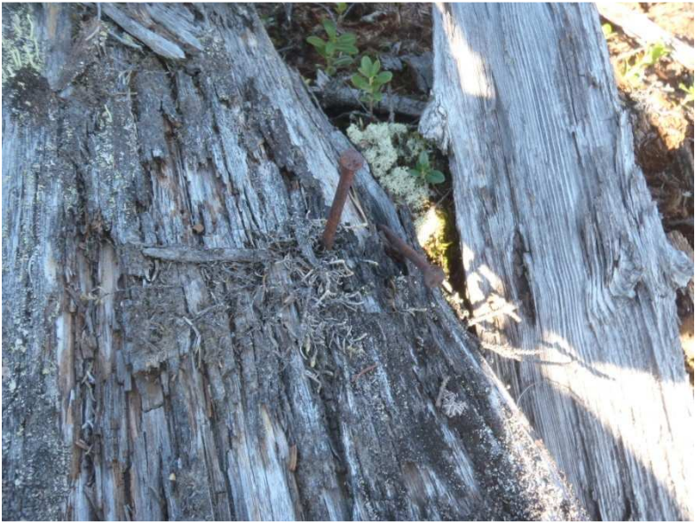
Kuva 172966_3 Kokkokangas 4 rakennusjännös. Yksityiskohtakuva. Hirsiseinien hajonneita jännöksiä nauloineen.
