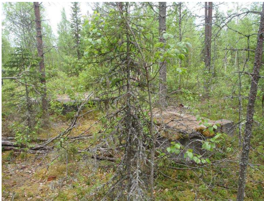
Rakennuksen betonisia jätteitä.
